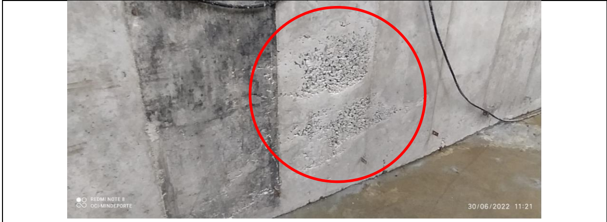
Foto 9. Cuarto de Máquinas piscina
