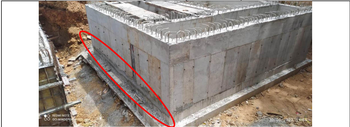
Foto 7. Tanque de Almacenamiento de Agua Potable y Cuarto de Máquinas
