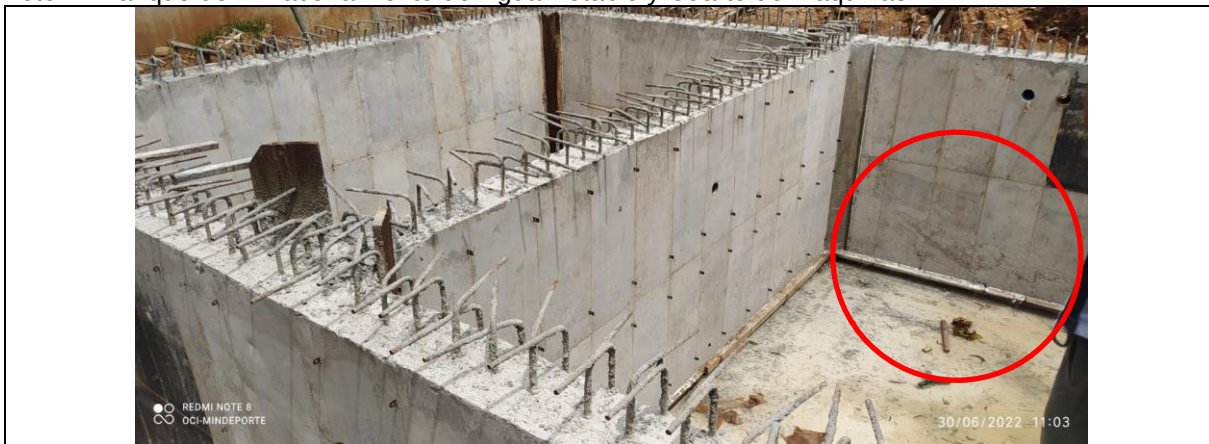
Foto 4. Tanque de Almacenamiento de Agua Potable y Cuarto de Máquinas
