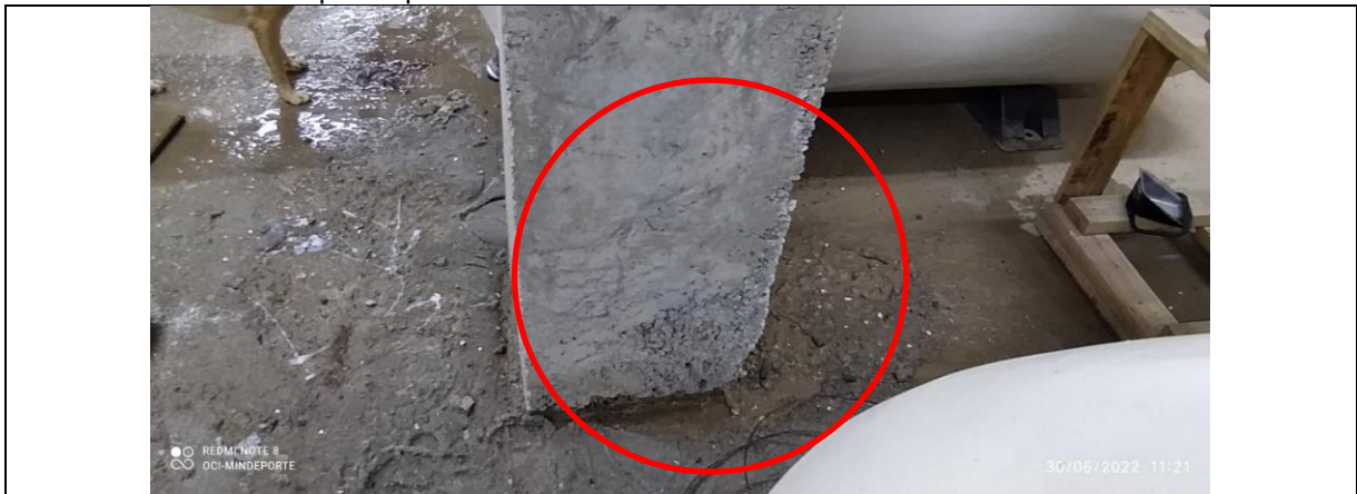
Foto 10. Cuarto de Máquinas piscina
