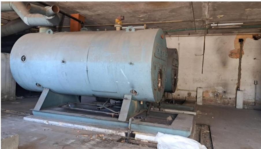
Zona de calderas
