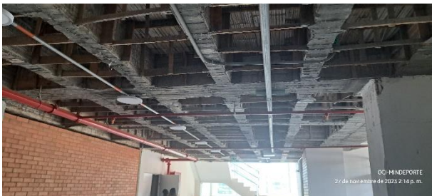
Estado techos pasillo
