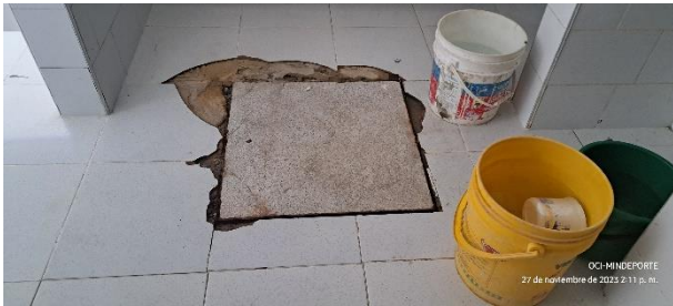
Estado piso baño
