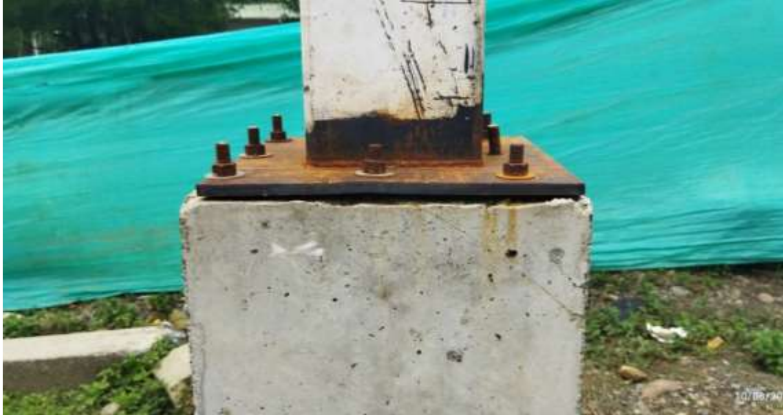
Corrosión en las platinas de anclaje entre pedestales en concreto y columnas metálicas.
