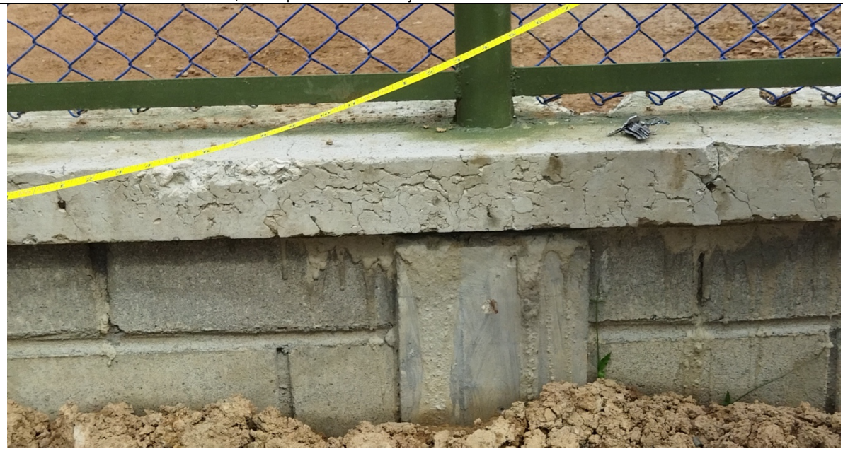
Foto 2. Cerramiento No. 1252/2020, Municipio de María la Baja – Bolívar.
