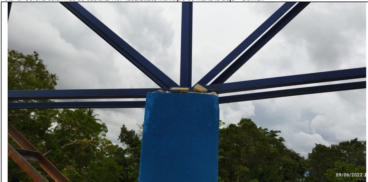
Foto 3. Corona columnas de cubierta No. 1252/2020, Municipio de María la Baja – Bolívar.
