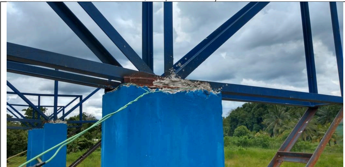
Foto 5. Corona columnas de cubierta No. 1252/2020, Municipio de María la Baja – Bolívar.
