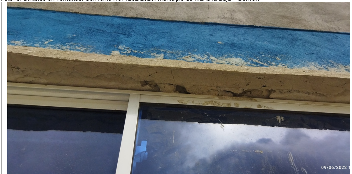
Foto 8. Dinteles en ventanas. Convenio No. 1252/2020, Municipio de María la Baja – Bolívar.
