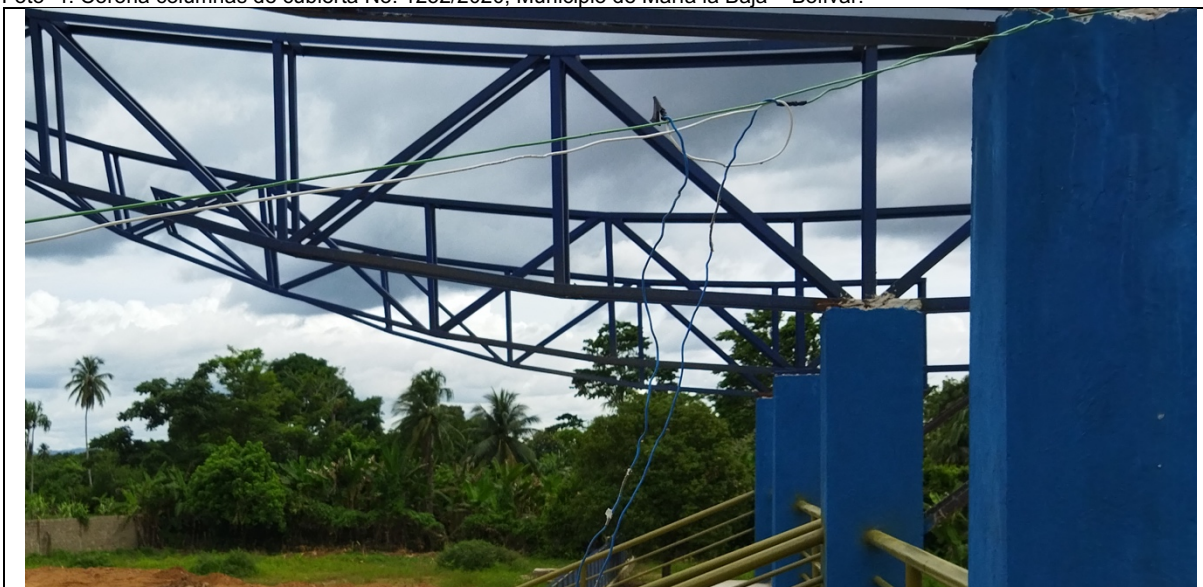
Foto 4. Corona columnas de cubierta No. 1252/2020, Municipio de María la Baja – Bolívar.
