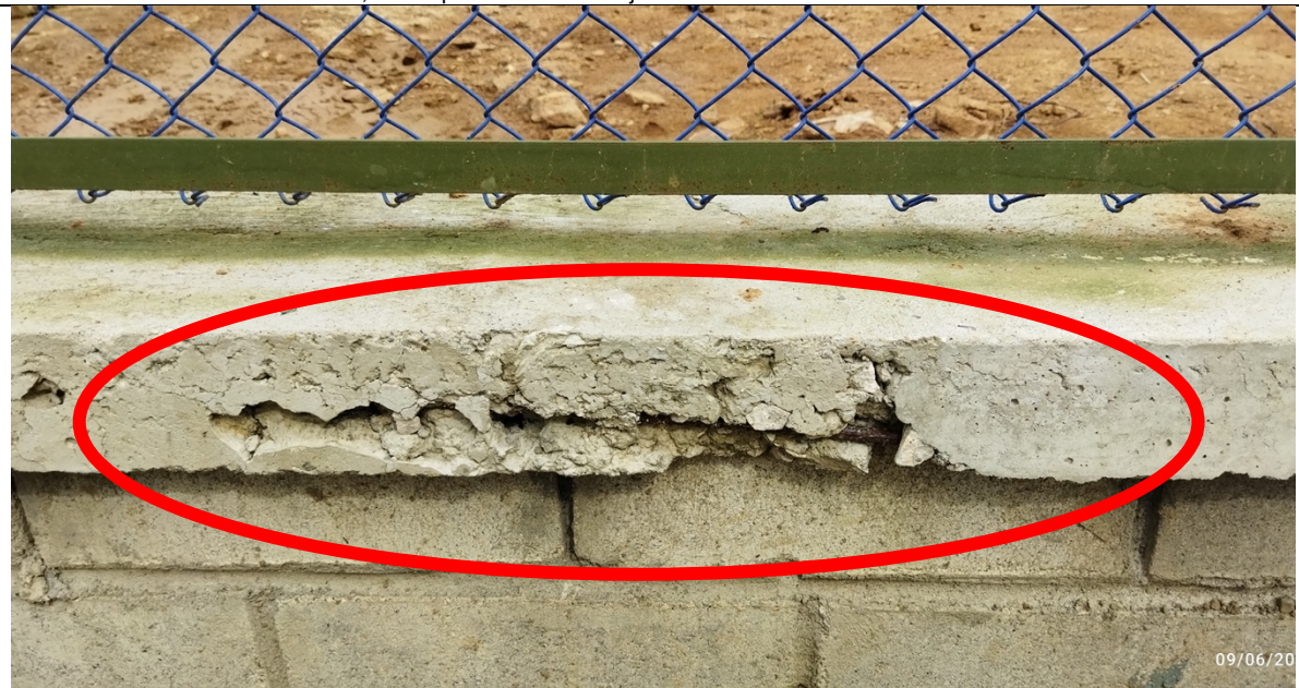
Foto 1. Cerramiento No. 1252/2020, Municipio de María la Baja – Bolívar.
