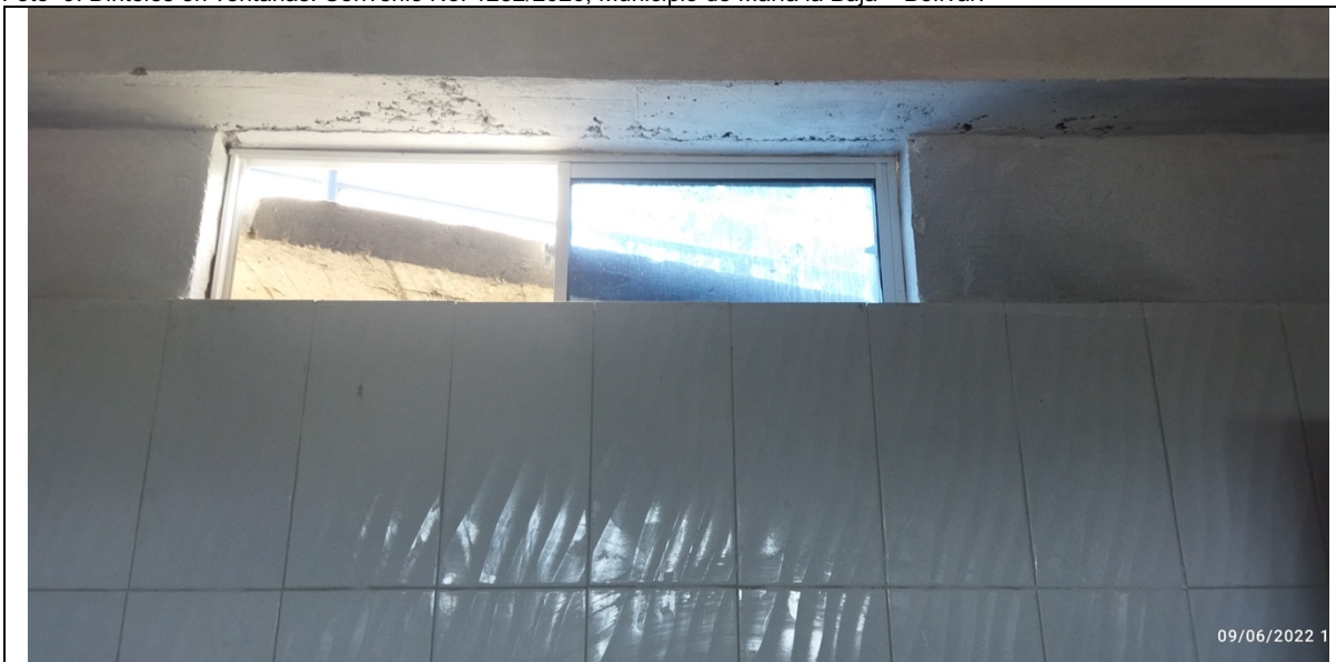
Foto 9. Dinteles en ventanas. Convenio No. 1252/2020, Municipio de María la Baja – Bolívar.
