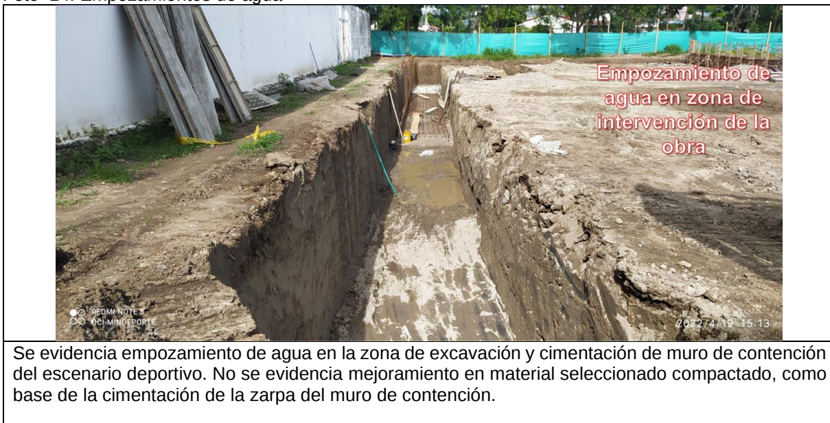
Foto 14. Empozamientos de agua
