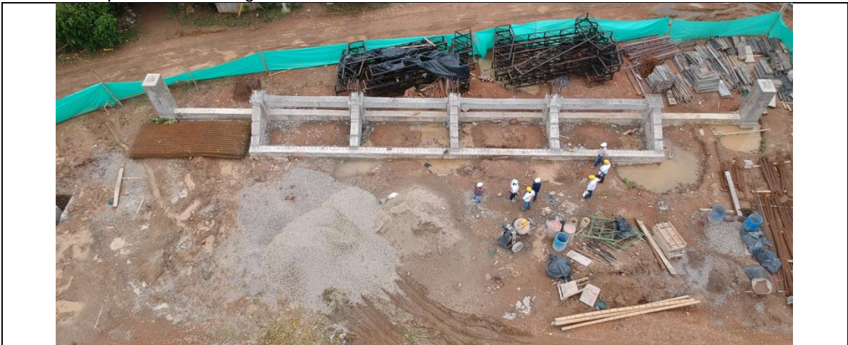
Foto 11. Empozamiento de agua en zonas de la obra
