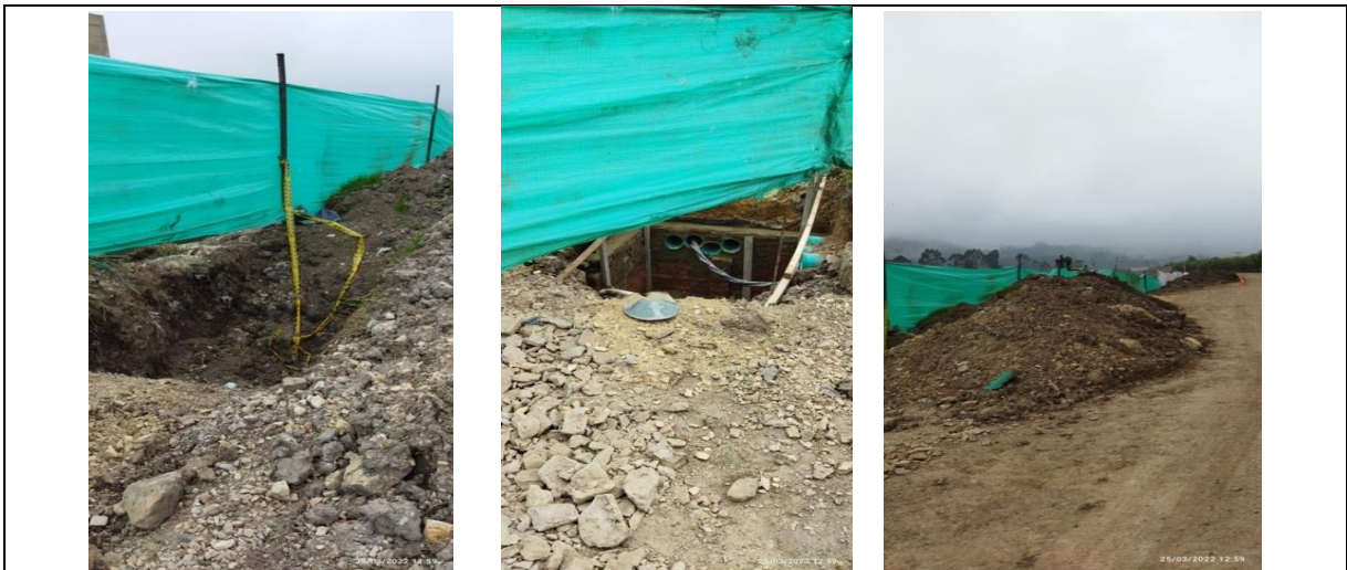
Foto 6. Señalización zonas de riesgo o peligro Convenio No. 1220/2020, Municipio de Bojacá - Cundinamarca
