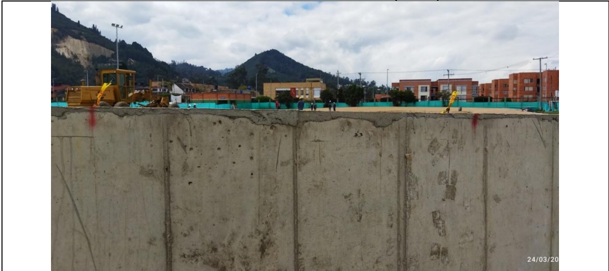
Foto 24. Calidad de la obra Convenio No. 1237/2020, Municipio Sopo, Cundinamarca
