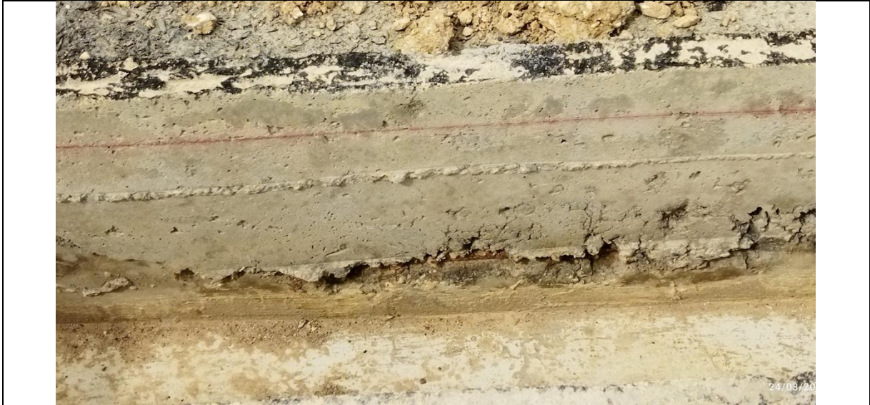
Foto 22. Calidad de la obra Convenio No. 1237/2020, Municipio Sopo, Cundinamarca
