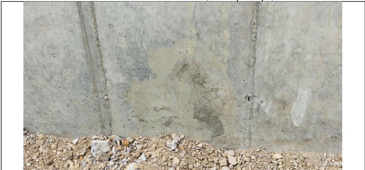
Foto 23. Calidad de la obra Convenio No. 1237/2020, Municipio Sopo, Cundinamarca
