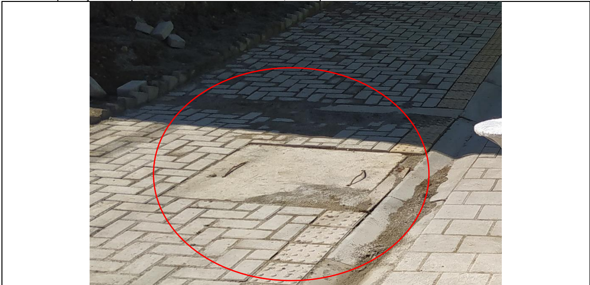
Foto 21. Tapas cajas de inspección Convenio No. 1056/2020, Municipio de Buesaco – Nariño
