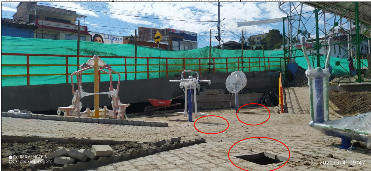
Foto 22. Señalización de zonas de riesgo en obra, Convenio No. 1056/2020, Municipio de Buesaco – Nariño.
