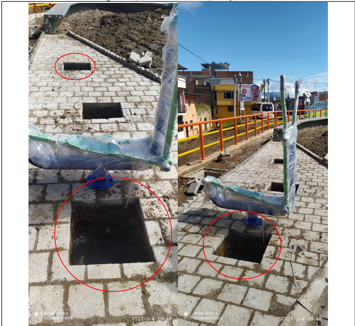
Foto 23. Señalización de zonas de riesgo en obra, Convenio No. 1056/2020, Municipio de Buesaco – Nariño.
