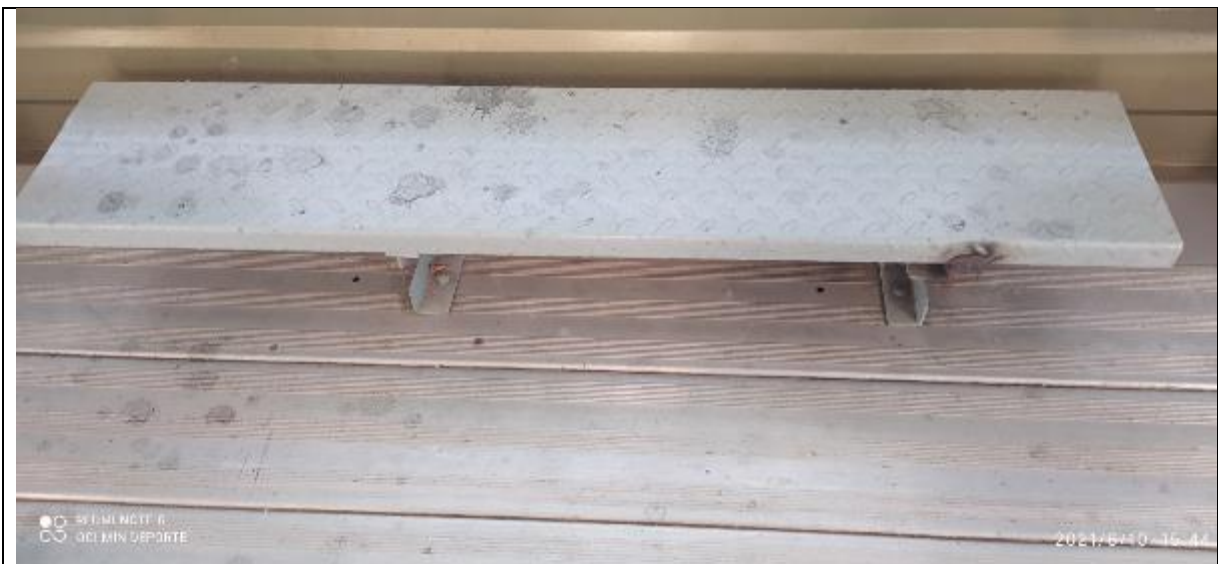
Foto No. 22. Evidencia de detalles constructivos que no cumplen especificación técnica en obras realizadas en gradería.
