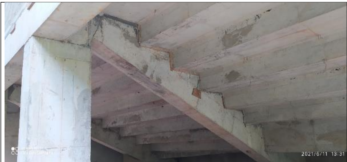
Foto No. 26. Se evidencia presencia elementos del encofrado del concreto, debajo y en los costados de la gradería de la Pista de Patinaje del Centro Deportivo Guatiguara del municipio de Piedecuesta Santander.
