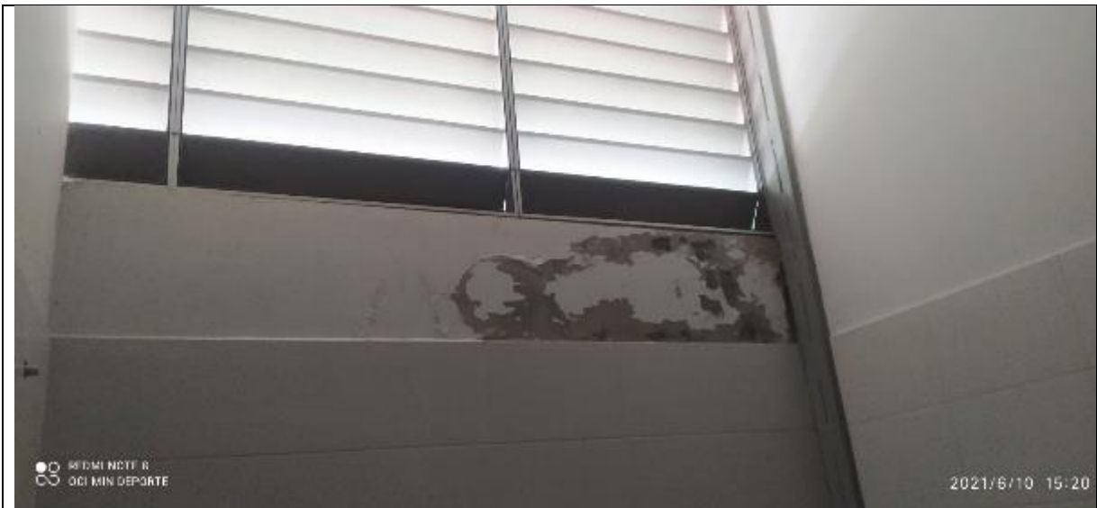
Foto No. 21. Evidencia de humedad en muros cercanos a ventanas.
