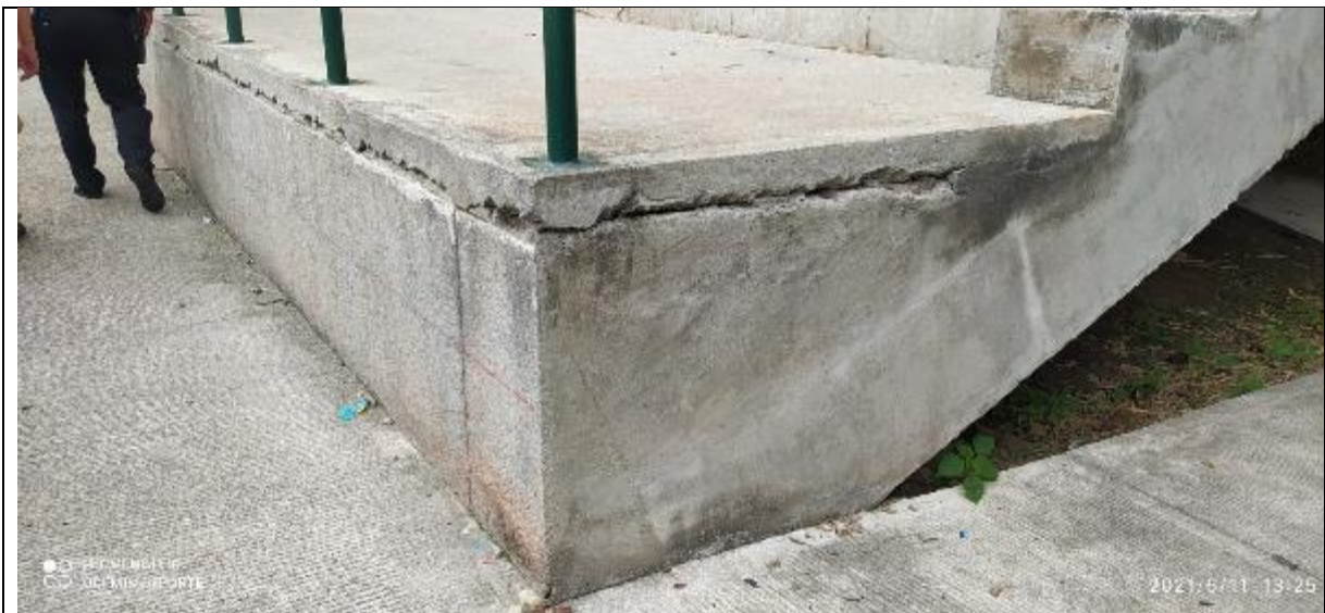
Foto No. 24. Se evidencia fisuras y desprendimiento de mortero de pañete en gradería de la Pista de Patinaje del Centro Deportivo Guatiguara del municipio de Piedecuesta Santander.
