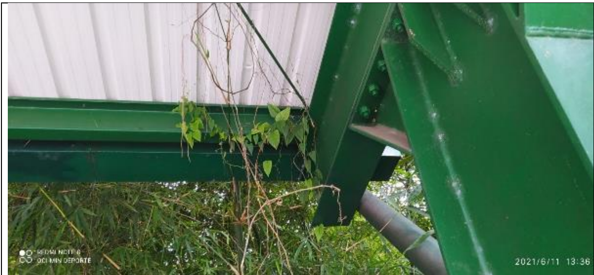
Foto No. 29. Se evidencia presencia de vegetación en contacto con estructura de cubierta de la gradería de la Pista de Patinaje del Centro Deportivo Guatiguara del municipio de Piedecuesta Santander.
