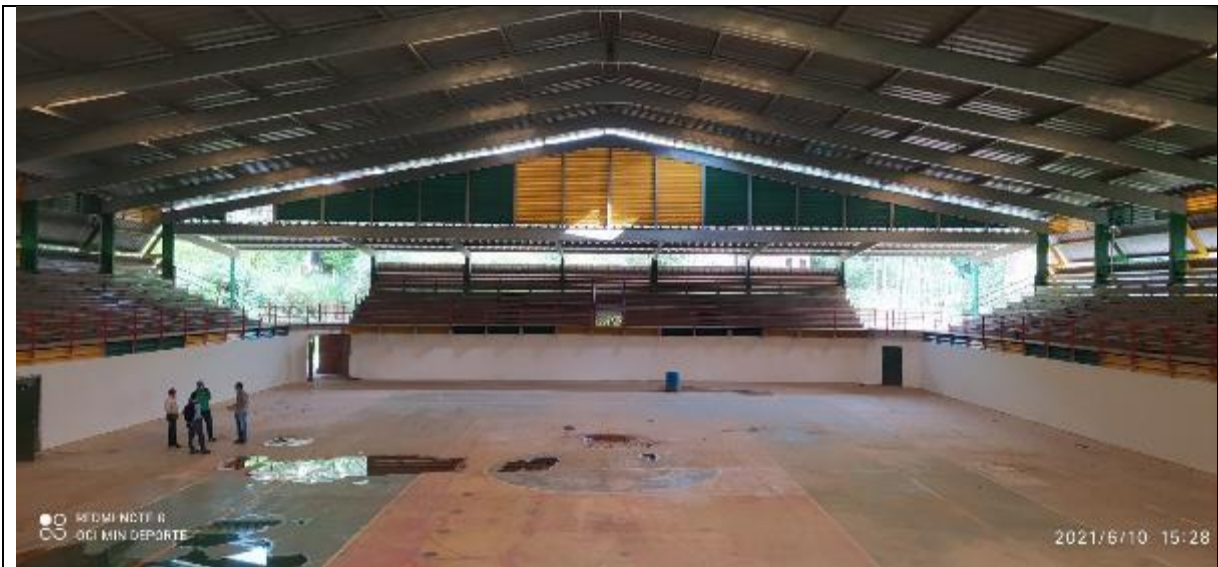
Foto No. 19. Estado actual Polideportivo Villa Olímpica del municipio de Floridablanca Santander. Se evidencia agua en el sector en el cual se realizará instalación de piso en Maderamen.
