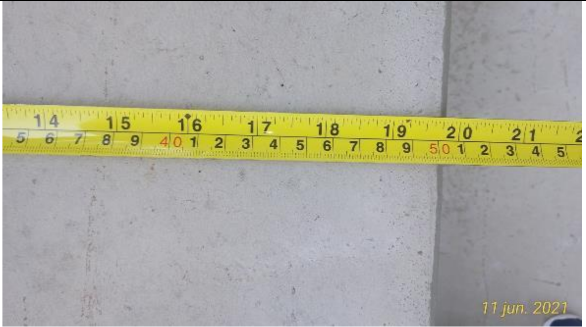
Foto No. 14 Se evidencia medida de 50 cm en huella de graderías, área destinada a circulación, permanencia de espectador y transito a graderías superiores. OCI 11/06/2021
