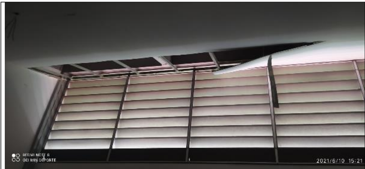
Foto No. 20. Evidencia de desprendimiento de cielo raso por humedad.
