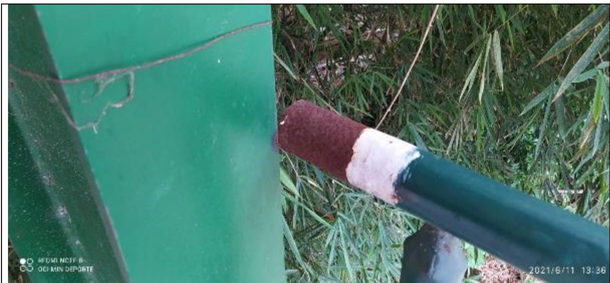
Foto No. 28. Se evidencia falta de pintura en baranda perimetral de gradería, parte superior, lo cual genera corrosión en el elemento gradería de la Pista de Patinaje del Centro Deportivo Guatiguara del municipio de Piedecuesta Santander.
