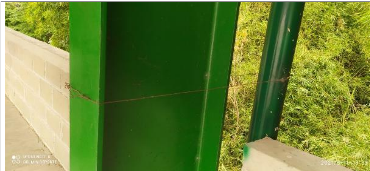
Foto No. 27. Se evidencia inadecuado aseguramiento de bajantes de aguas lluvias de la cubierta de la gradería de la Pista de Patinaje del Centro Deportivo Guatiguara del municipio de Piedecuesta Santander.
