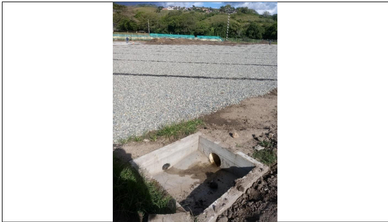
Foto N°21, caja de recolección aguas drenaje cancha de futbol. Foto: equipo auditor Oficina de Control Interno. 13-06-2019
