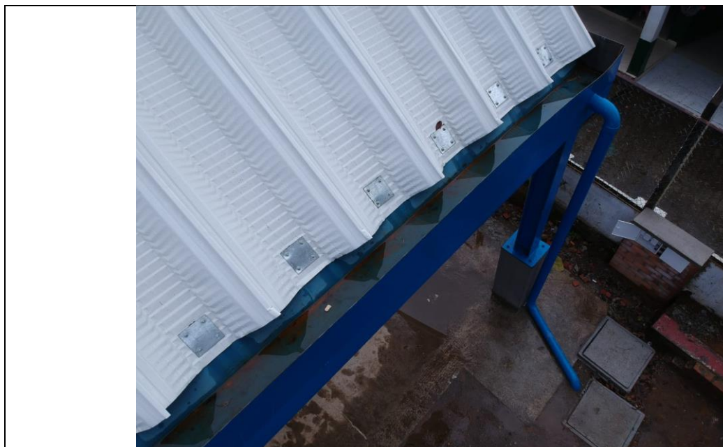
Foto N°5, viga canal metálica. Foto: equipo auditor Oficina de Control Interno. 12 -06-2019
