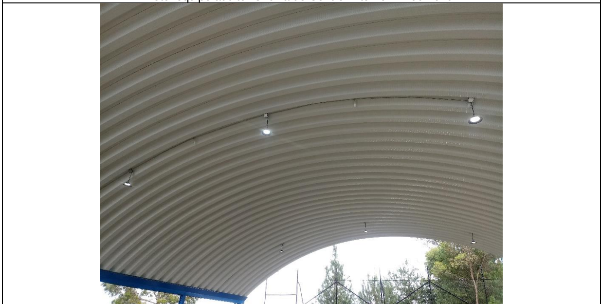
Foto N°4, Iluminación cancha, 9 lámparas. Foto: equipo auditor Oficina de Control Interno. 12 -06-2019.
