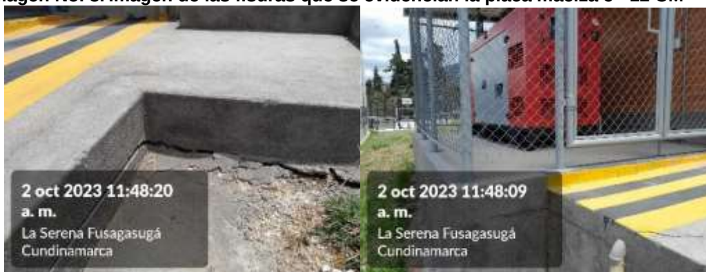
Imagen No. 3. Imagen de las fisuras que se evidencian la placa maciza e= 12 CM
