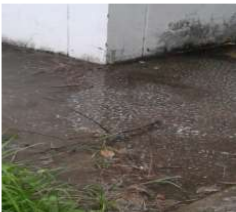
Fotografía N° 496. Corredores perimetrales inundados
