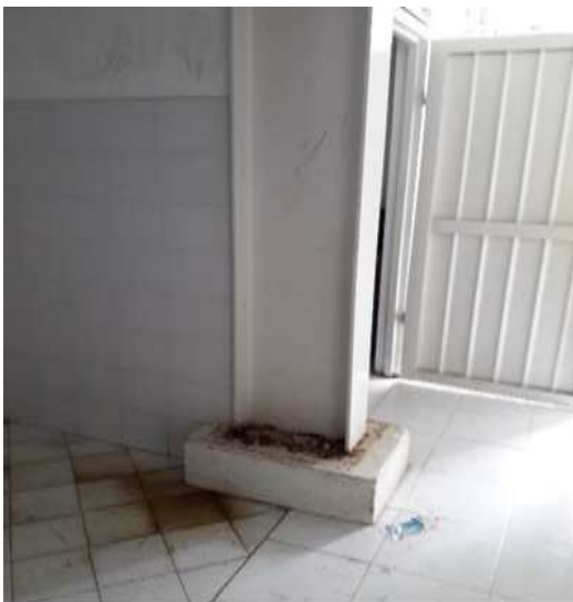
Fotografía N° 482. Oxidación Perfil metálico, Sector Baños
