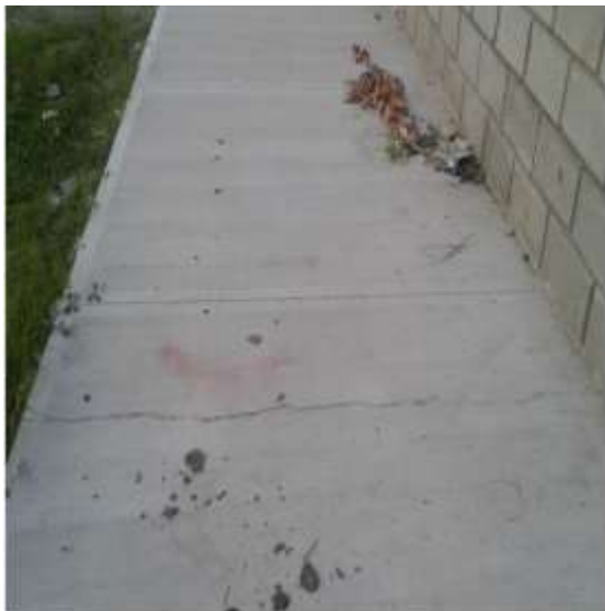
Fotografía N° 480. Agrietamiento anden perimetral
