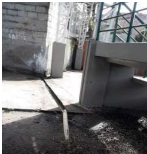
Fotografía N° 547. ubería aguas lluvias expuesta y averiada
