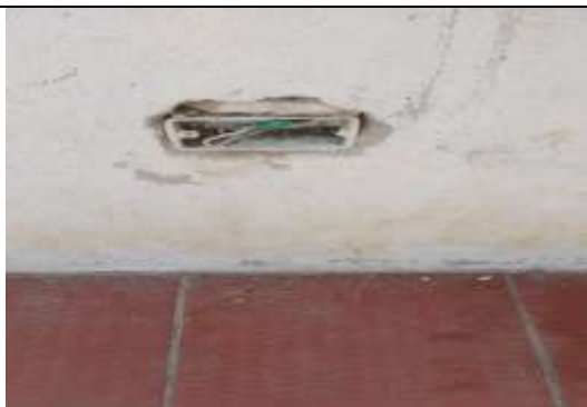
Fotografía 34 Robo de tomacorrientes
