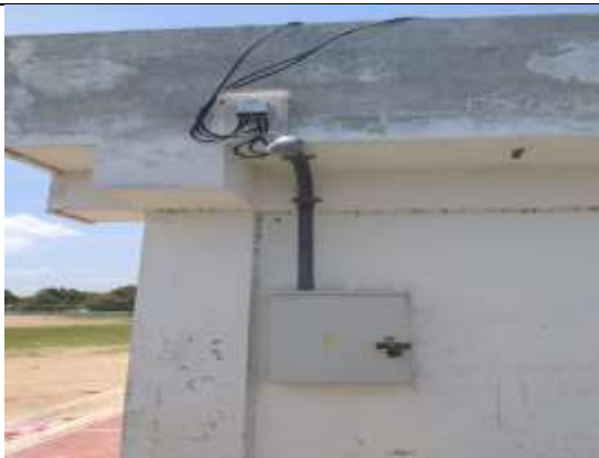
Fotografía 33 Cables eléctricos expuestos
