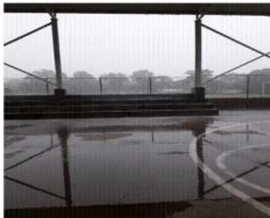
Fotografía N° 501. Rejilla Polideportivo rebosada
