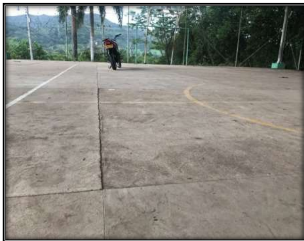
Fotografía N° 536. Evidencia severo aumento tamaño dilataciones
