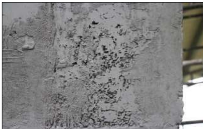
Fotografía 183. Detalle de la superficie de una columna de concreto. Se evidenció en varias secciones de los concretos contruidos (columnas y vigas), hormigueo y material de agregado a la vista.
