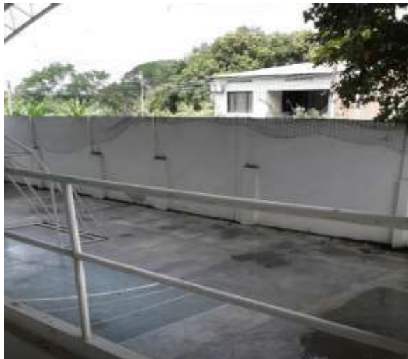
Fotografía N° 491. Encharcamiento cancha del polideportivo
