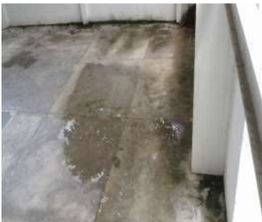
Fotografía N° 492. Encharcamiento deterioro piso Polideportivo
