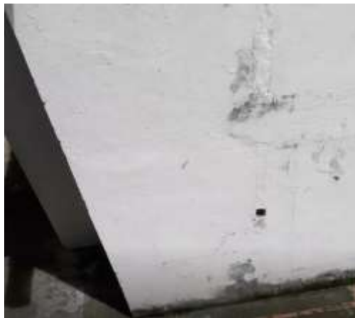
Fotografía N° 485. Pared agrietada del Polideportivo
