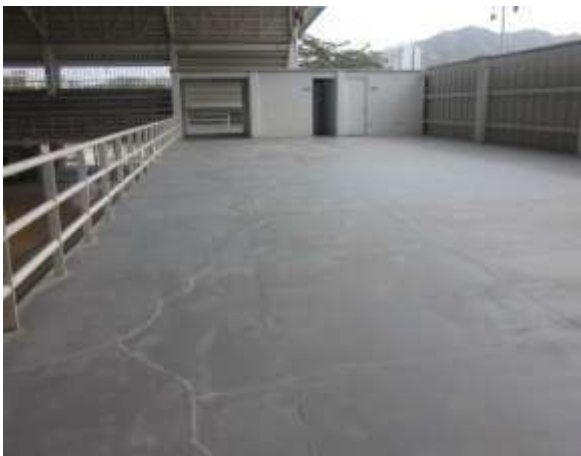
Fotografía 303 Fisuras en placa mezanine – segundo nivel
