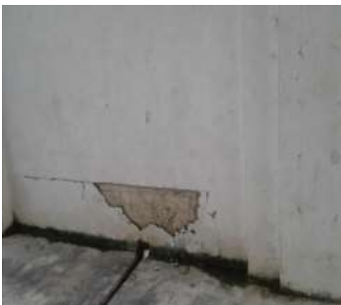
Fotografía N° 486. Deterioro pared polideportivo
