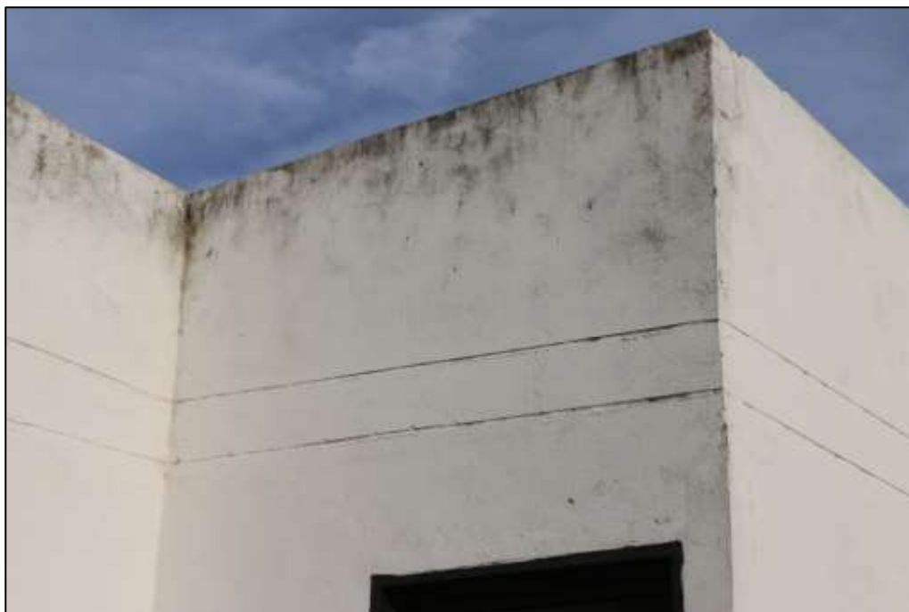
Fotografía 346 profesional. En estos sitios, se evidenció lavado diferencial y manchado del acabado de estos muros.
