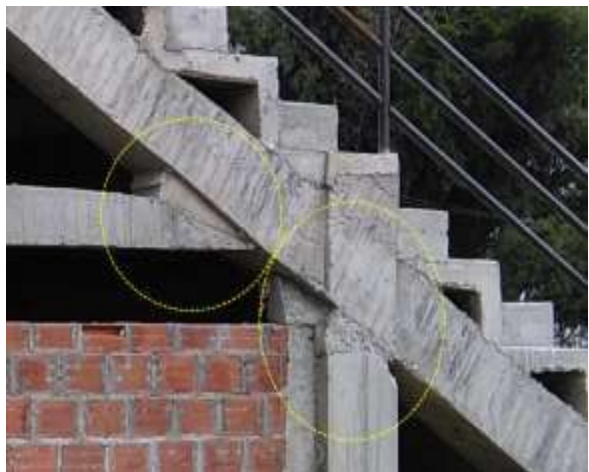
Fotografía 436 Incorrecta conformación del confinamiento en conexiones
