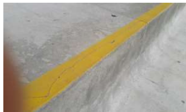
Fotografía N° 569. Degradación de los bordes
