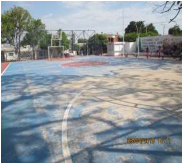
Fotografía 139. Muestra desprendimiento pintura de la cancha multifuncional
