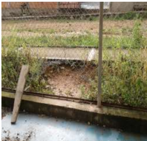
Fotografía N° 521. Malla eslabonada rota
