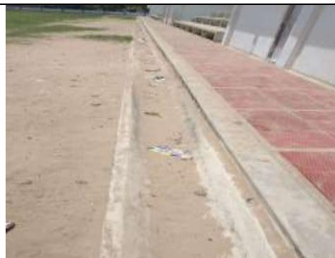
Fotografía 35 Canales de desagües con arena
