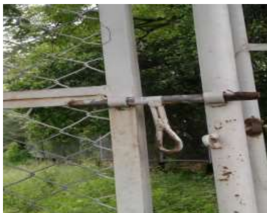
Fotografía N° 503. Portón en estado de oxidación
