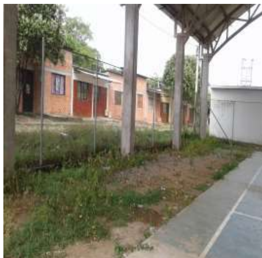
Fotografía N° 519. Cerramiento con maleza
