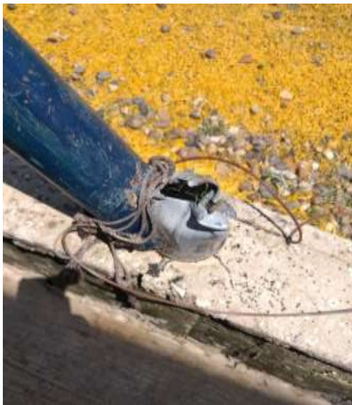
Fotografía 26 Sin tubería de soporte de malla
