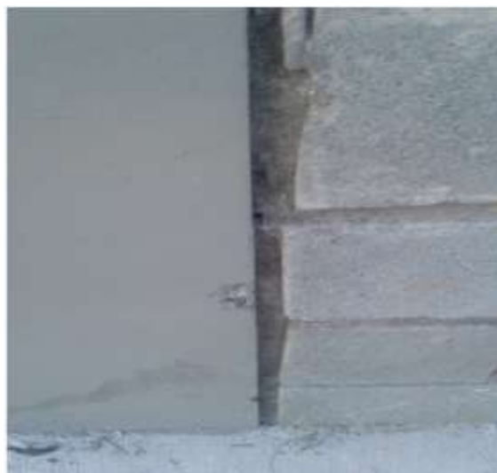
Fotografía N° 479. Acabado irregular costado de las escaleras
