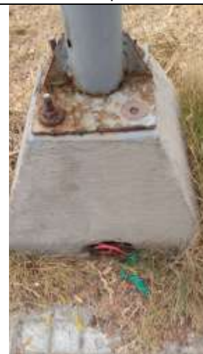
Fotografía 4 Instalaciones eléctricas expuestas y postes con óxido
