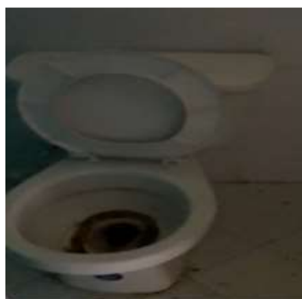
Fotografía N° 499. Baños en deterioro
