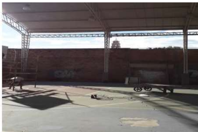
Fotografía N° 540. Recubrimiento reparado (Parche azul claro) y averiado
