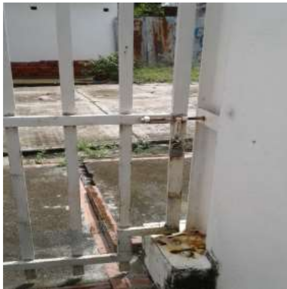
Fotografía N° 483. Proceso oxidación puerta Polideportivo
