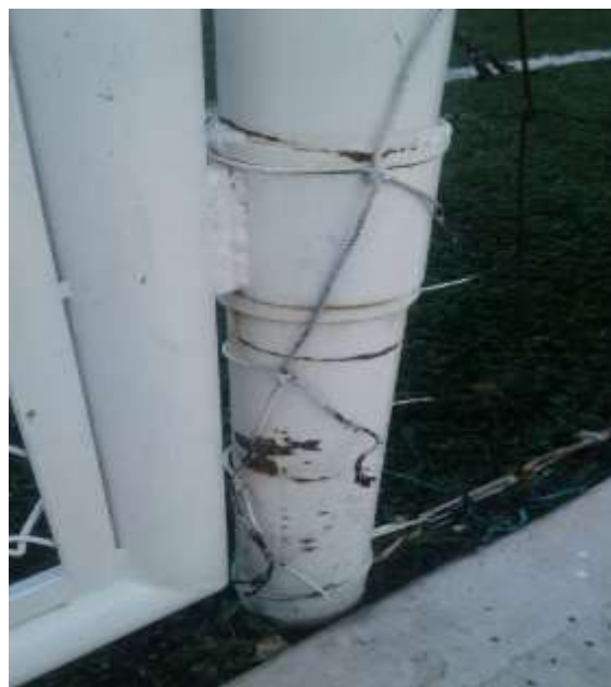
Fotografía N° 477. Pintura en mal estado puerta de entrada
