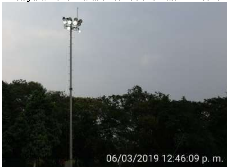
Fotografía 119 Luminarias sin servicio en el mástil # 2 – Son 5
