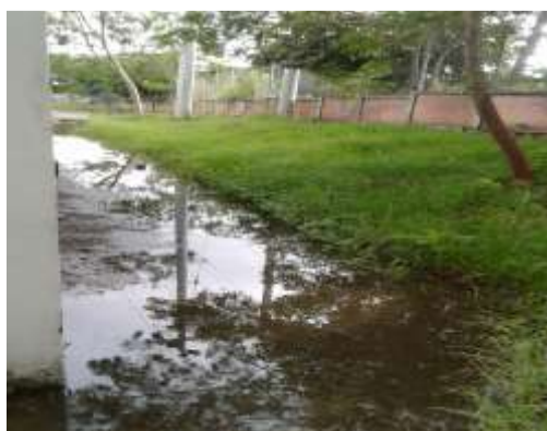
Fotografía N° 497. Corredores y andenes periféricos inundados
