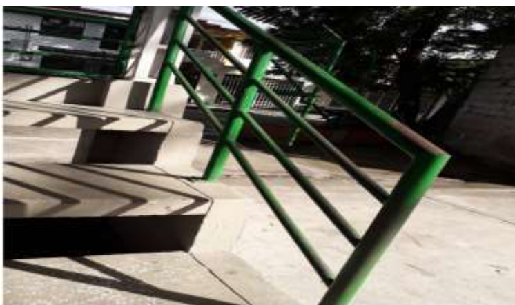
Fotografía N° 548. Baranda gradería oxidada
