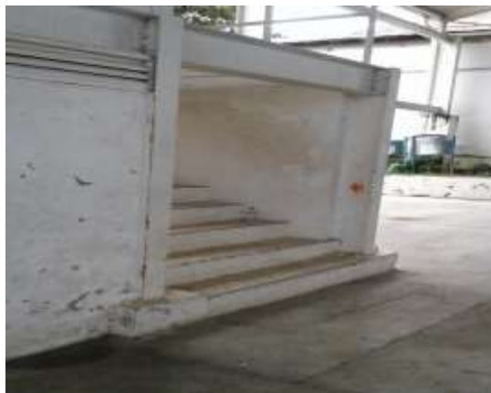
Fotografía N° 487. Falta de pintura y deterioro pared Polideportivo
