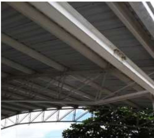
Fotografía N° 484. Proceso Oxidación estructura de la cubierta
