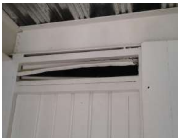
Fotografía N° 493. Daño en puerta baños
