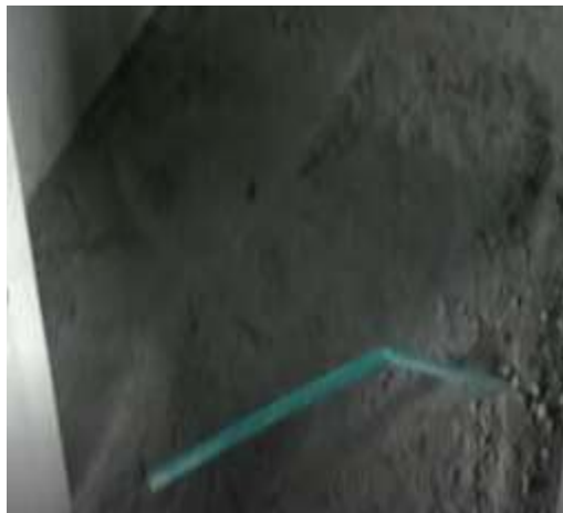
Fotografía N° 535. Rotura y exposición de tubos
