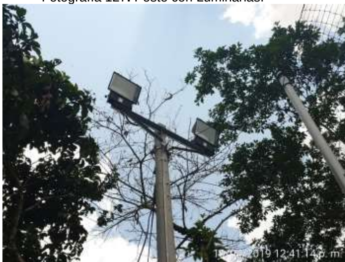
Fotografía 127. Poste con Luminarias.
