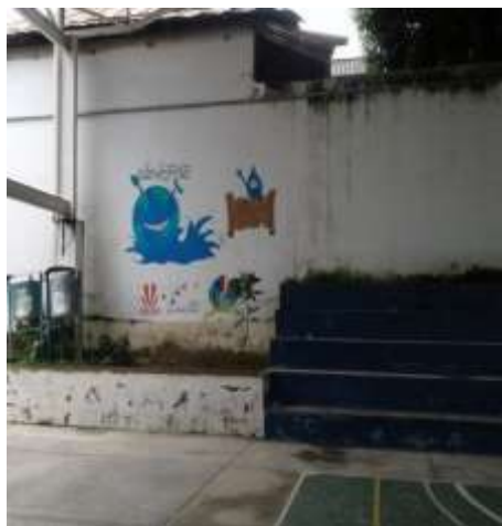
Fotografía N° 488. umedad y falta de pintura Polideportivo
