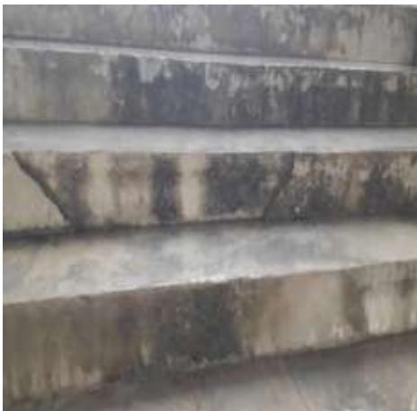
Fotografía N° 494. Grietas graderías polideportivo
