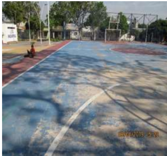
Fotografía 140. Muestra desprendimiento pintura de la cancha multifuncional.
