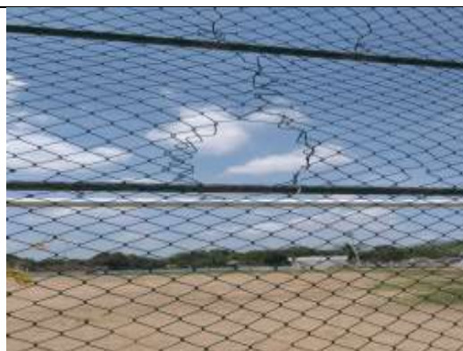
Fotografía 37 Malla rota detrás de porterías
