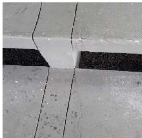
Fotografía N° 545. Gradería agrietada o fisurada
