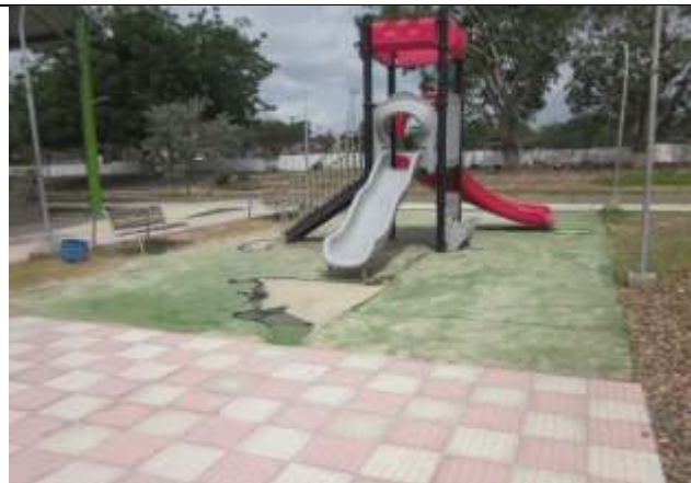
Fotografía 1 Recubrimiento zona infantil en mal estado
