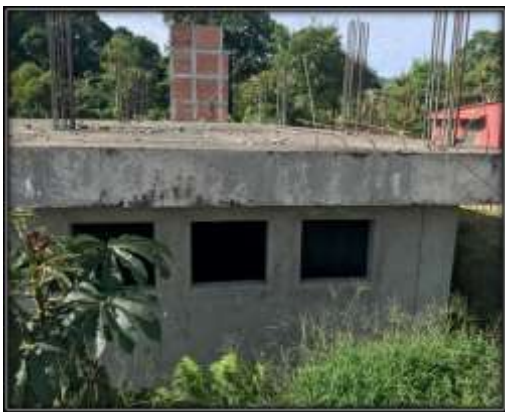
Fotografía N° 530. Obras suspendidas y abandonadas
