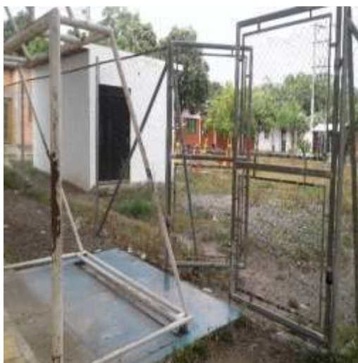
Fotografía N° 522. Estructura de las canchas oxidadas
