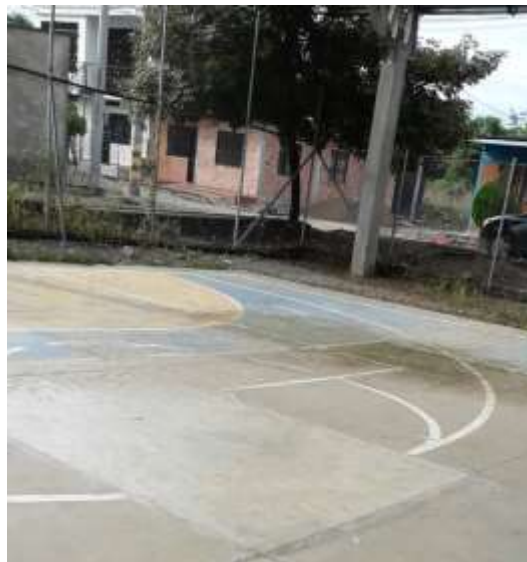
Fotografía N° 525. Huellas del empozamiento de agua
