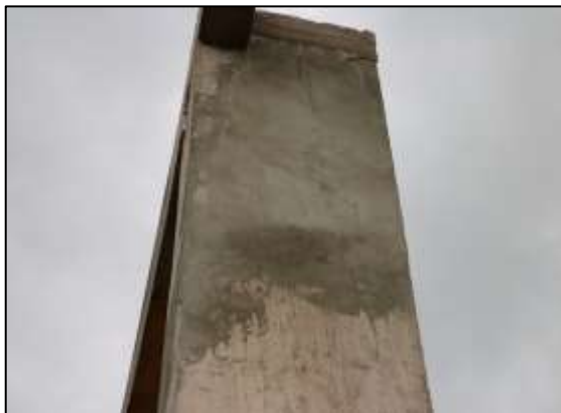
Fotografía 182. Detalle del nudo superior en otro de los pórticos de concreto contruidos. En esta imagen se aprecia una reparación realizada en la superficie de un concreto, la cual consistió en la aplicación de mortero tradicional sobre una superficie fría y endurecida. De esta manera, la reparación no es efectiva y facilita el desprendimiento del mortero.
