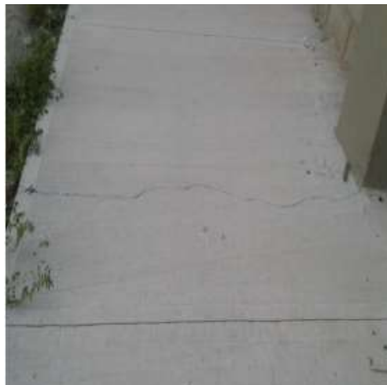
Fotografía N° 481. Agrietamiento anden perimetral
