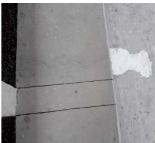
Fotografía N° 544. Gradería agrietada y levantada
