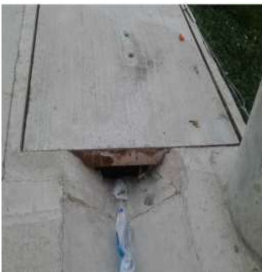
Fotografía N° 478. Oxido en la caja de empalme
