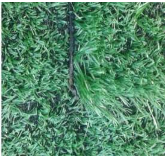
Fotografía N° 474. nstalación irregular Grama sintética
