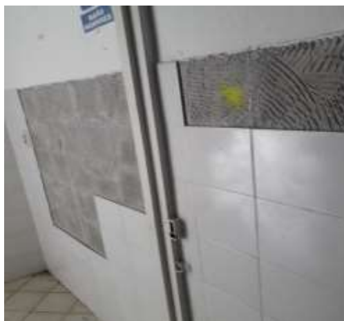
Fotografía N° 489. Desprendimiento de baldosas pared sector baños Polideportivo
