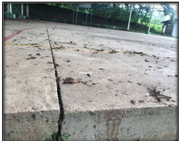
Fotografía N° 537. Evidencia severo aumento tamaño dilataciones
