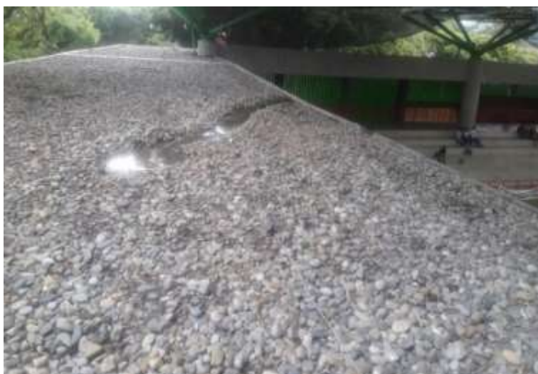
Fotografía N° 558. Empozamiento del agua en la cubierta
