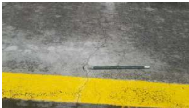
Fotografía N° 567. Fisuras presentadas en las huellas
