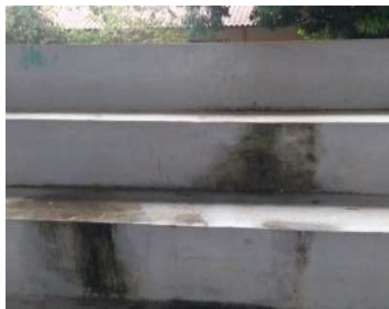
Fotografía N° 514. Detalle de humedades en las graderías
