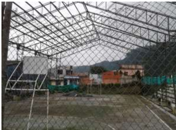
Fotografía N° 466. Estructura Polideportivo Barrio Jaramillo a la intemperie.
