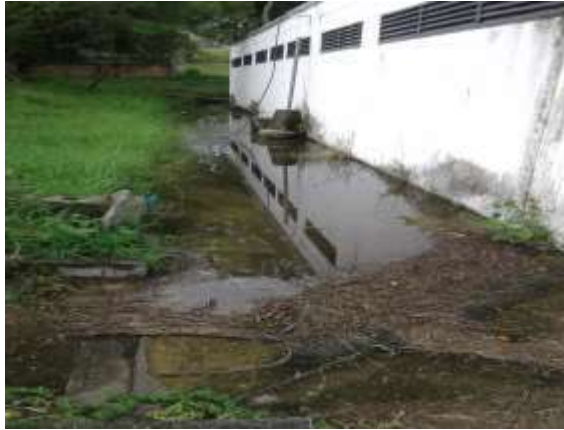
Fotografía N° 511. Anegación del área perimetral
