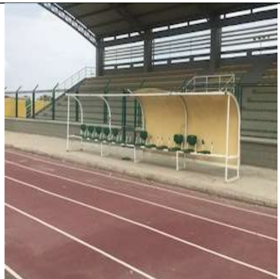
Fotografía 298 Bancas técnicas en mal estado
