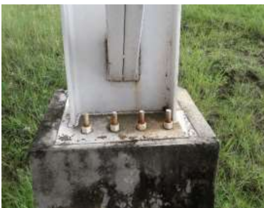
Fotografía N° 502. Columna estructura Polideportivo en estado de oxidación
