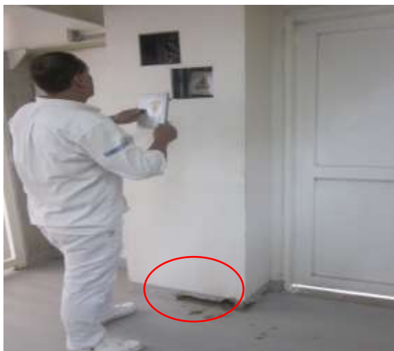
Fotografía 305 Deterioro parte inferior Drywall – columna falsa-
