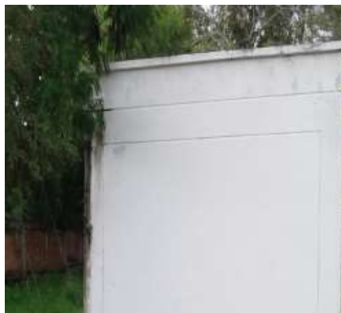
Fotografía N° 495. Grietas pared baños
