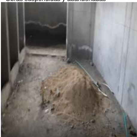
Fotografía N° 532. Humedades paredes y materiales
