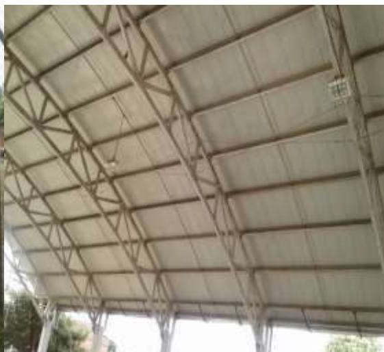
Fotografía N° 523. Estructura de cubierta en estado de oxidación
