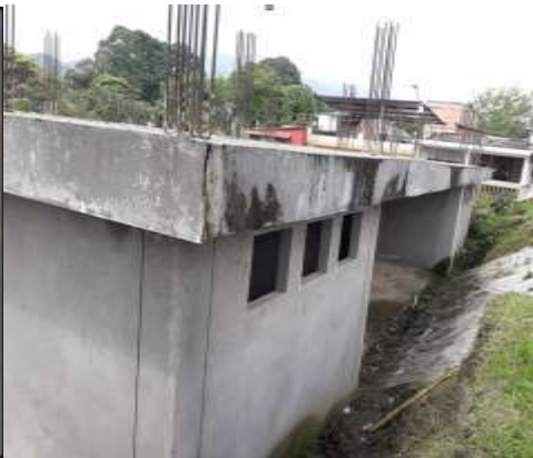
Fotografía N° 531. Obras suspendidas y abandonadas
