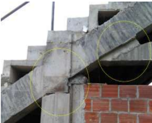
Fotografía 435 Incorrecta conformación del confinamiento en conexiones
