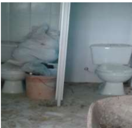
Fotografía N° 498. Baños en deterioro
