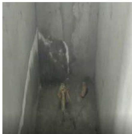
Fotografía N° 533. Humedades paredes baños
