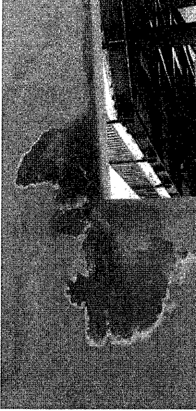
Fotografía N° 4. Detalle de una viga de concreto ubicada en el segundo tramo de la rampa de acceso al partidor de la pista. Misma lesión detallada en imágenes anteriores
