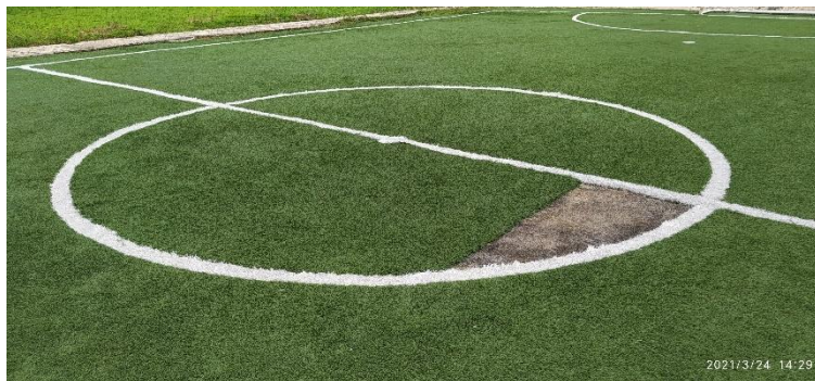
Foto N° 42. Desprendimiento de un pedazo de grama – OCI 24-03-2021
