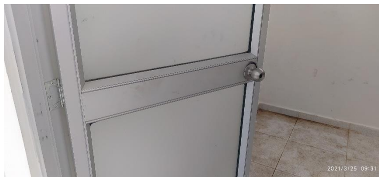
Foto N° 10. Desprendimiento de cerraduras – OCI 25-03-2021
