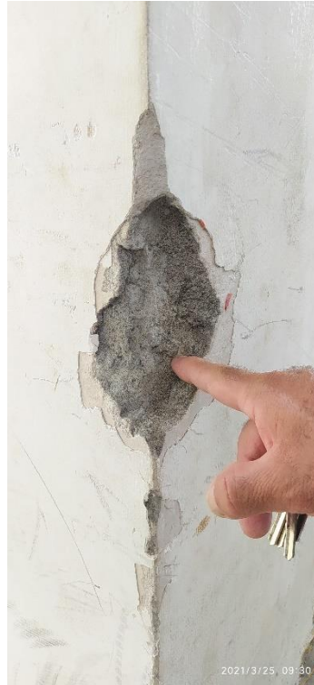
Foto N° 11. Desprendimiento de pañete – OCI 25-03-2021
