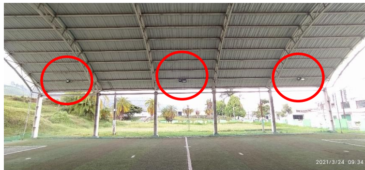
Foto N° 62. Sistema de iluminación de cancha – OCI 24-03-2021
