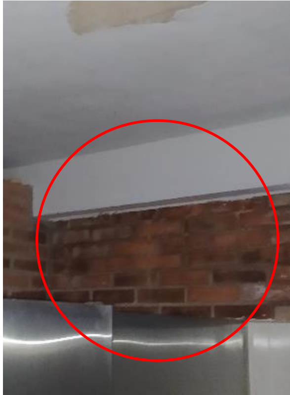
Foto N° 14. Humedad en parte superior de muros de muros y vestier – OCI 24-03-2021
