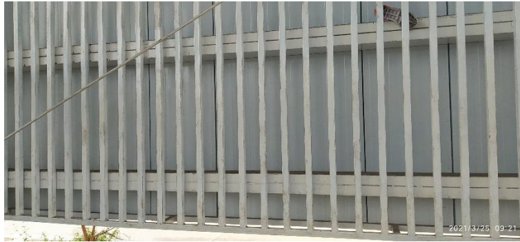
Foto N° 2. Inicios de corrosión parte inferior cerramiento costado – OCI 25-03-2021
