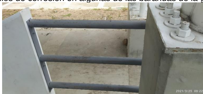
Foto N° 8. Inicios de corrosión en baranda gradería – OCI 25-03-2021
