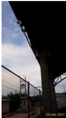
Foto N° 89 Canales Metálicas Rotas
