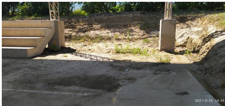
Foto N° 98. Sedimentos en cancha por erosión en talud – OCI 25-03-2021
