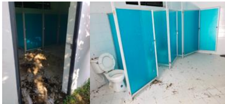
Foto N° 84 Baños sin Mantenimiento
