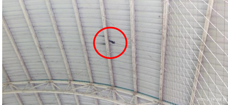
Foto N° 61. Orificio en teja de cubierta – OCI 24-03-2021
