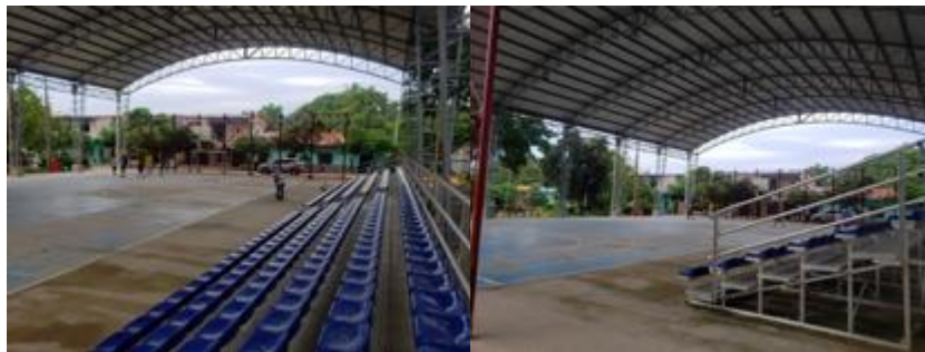
Foto N° 93 Espacio entre filas de Graderías Reducido que impide Transito y Evacuación
