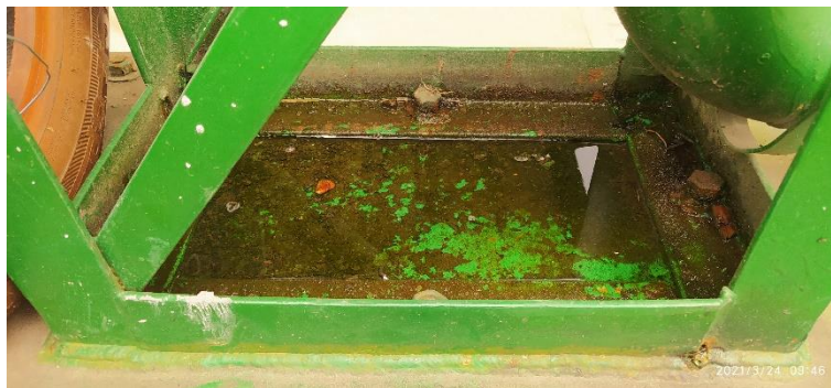
Foto N° 66. Empozamiento de aguas lluvias en base de algunas columnas – OCI 24-03-2021
