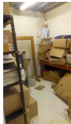
Foto N° 76 Cuarto Eléctrico como bodega
