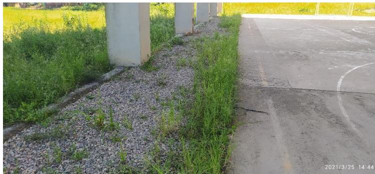
Foto N° 99. Vegetación en borde de la placa de la cancha – OCI 25-03-2021
