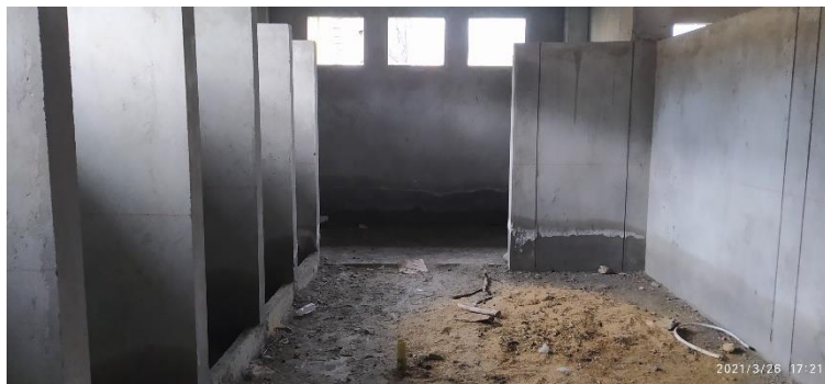
Foto N° 40. Humedad en parte inferior de muros internos – OCI 26-03-2021
