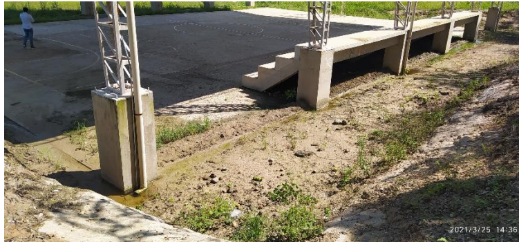
Foto N° 97. Empozamiento de aguas lluvias – OCI 25-03-2021
