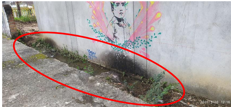
Foto N° 37. Empozamiento de agua en contorno de la construcción – OCI 26-03-2021
