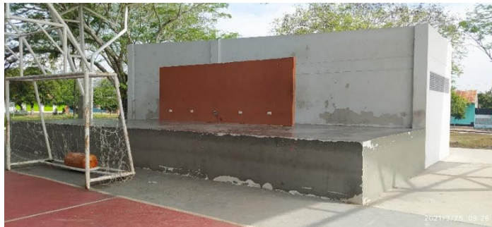
Foto N° 5. Desprendimiento pintura en muros – OCI 25-03-2021
