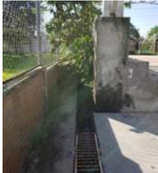
Foto N° 81 Cárcamos sin Rejillas
