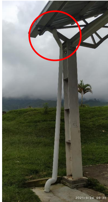
Foto N° 59. Falencia en aseguramiento de bajantes de aguas lluvias – OCI 24-03-2021
