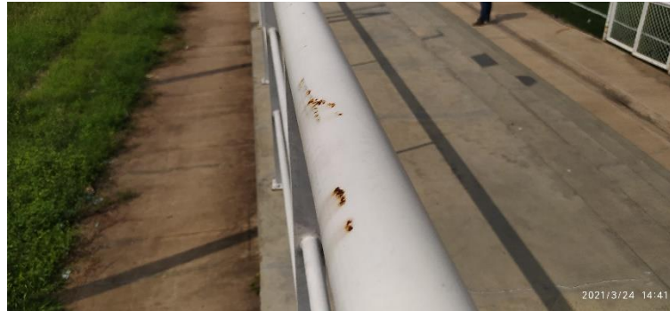
Foto N° 47. Corrosión en baranda de gradería – OCI 24-03-2021
