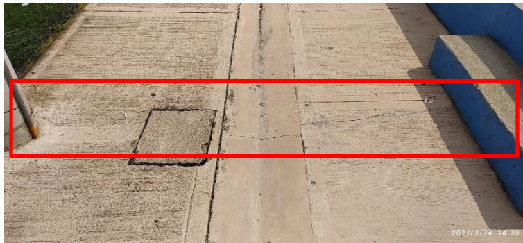
Foto N° 53. Fisuras en andén perimetral de la cancha – OCI 24-03-2021
