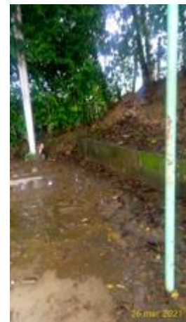
Foto N° 20. Talud sin canal de Desagüe
