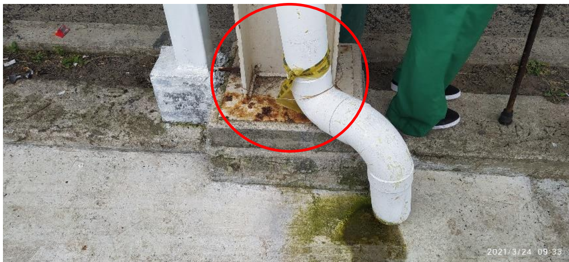
Foto N° 60. Corrosión en base de columnas – OCI 24-03-2021
