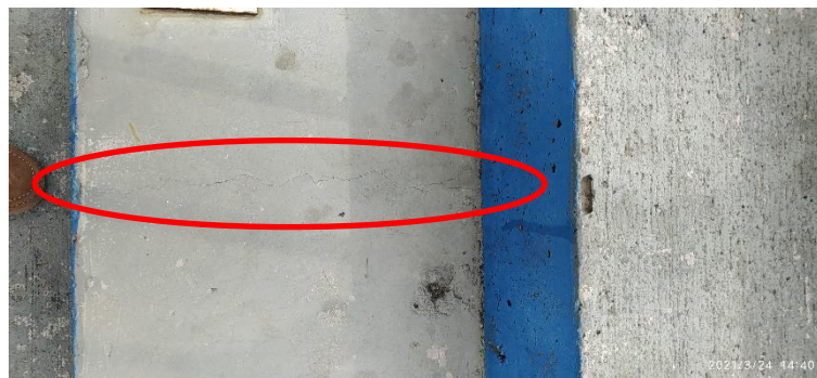
Foto N° 46. Fisuras en graderías – OCI 24-03-2021
