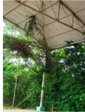
Foto N° 22. Vegetación invade estructura de cubierta
