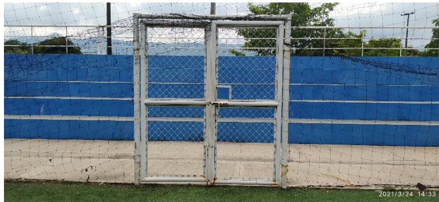
Foto N° 50. Corrosión en cerramiento de la cancha – OCI 24-03-2021
