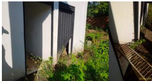
Foto N° 85 Carpintería Metálica Vandalizada
