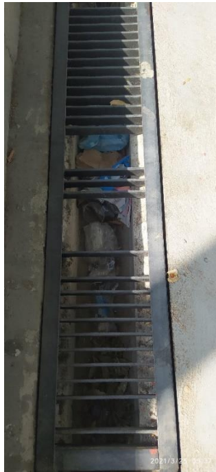
Foto N° 9. Rejilla de sumidero sin terminar, faltan elementos – OCI 25-03-2021
