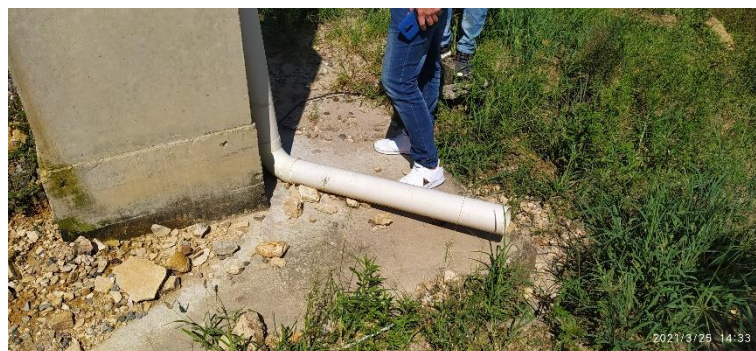
Foto N° 96. Deficiencia sistema de desagüe de aguas lluvias – OCI 25-03-2021
