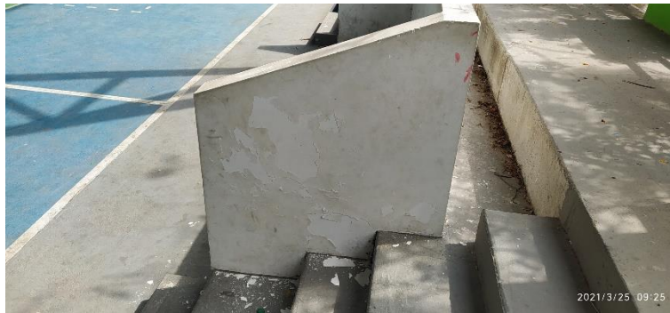
Foto N° 3. Desprendimiento pintura en muros – OCI 25-03-2021
