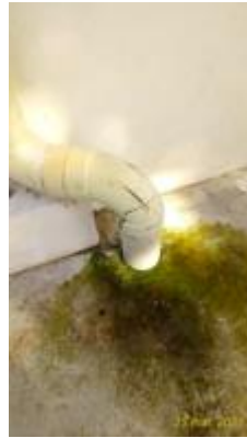
Foto N° 73 Bajante Aguas Lluvias rotas
