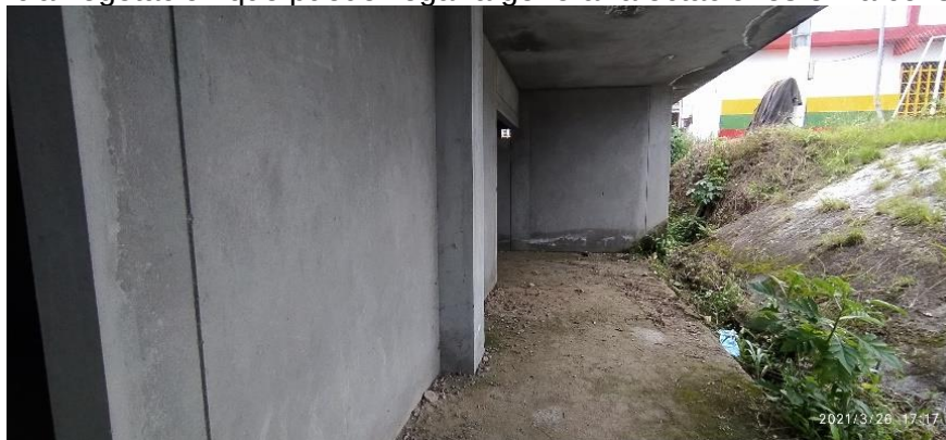
Foto N° 39. Crecimiento de vegetación en el contorno de la construcción – OCI 26-03-2021
