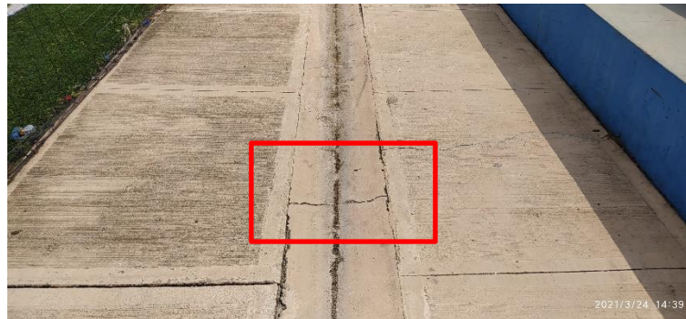
Foto N° 54. Fisuras en andén perimetral de la cancha – OCI 24-03-2021
