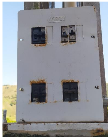
Foto N° 101. Corrosión en caja de tacos – OCI 25-03-2021
