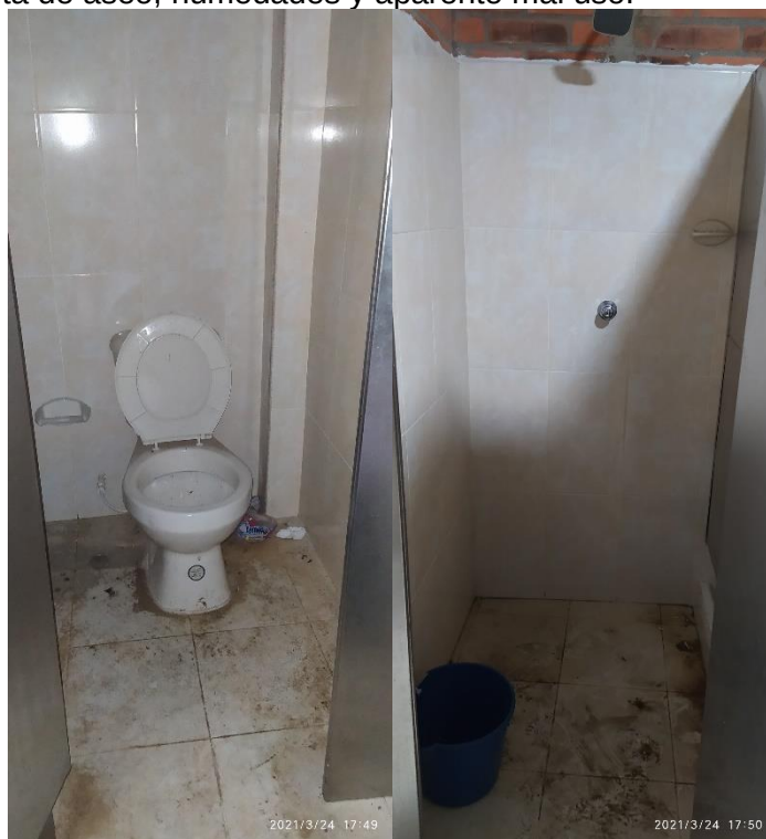
Foto N° 17. Falta de mantenimiento batería de baños – OCI 24-03-2021
