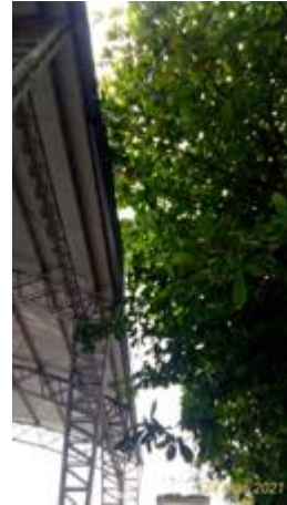
Foto N° 33 Deformación de Canales
