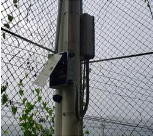
Foto N° 21. Caja eléctrica violentada
