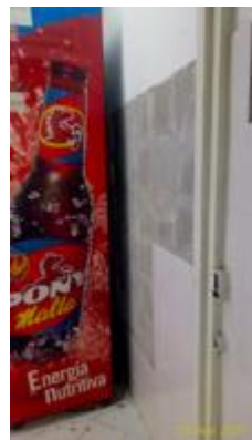
Foto N° 75 Falta de baldosas en paredes
