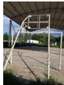
Foto N° 80 Marcos de Canchas sin Tableros
