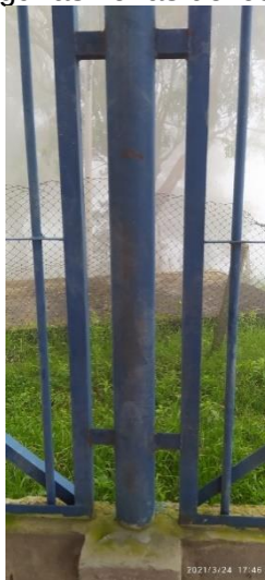
Foto N° 15. Inicio de corrosión en cerramiento – OCI 24-03-2021
