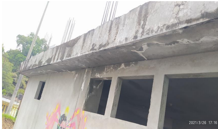
Foto N° 38. Humedad en losa superior y muros – OCI 26-03-2021
