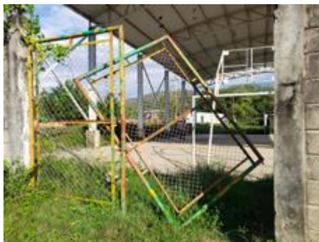
Foto N° 79 Deterioro Puertas de Villa Olímpica
