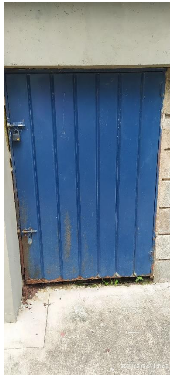
Foto N° 48. Corrosión en puerta para acceso interior graderías – OCI 24-03-2021
