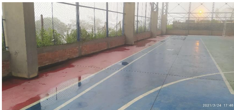
Foto N° 16. Empozamiento de aguas lluvias – OCI 24-03-2021
