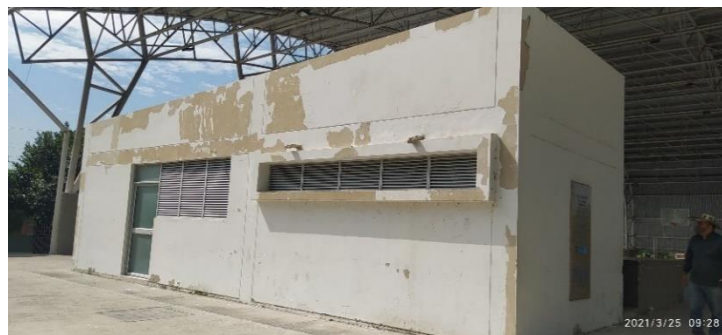
Foto N° 7. Desprendimiento pintura en muros – OCI 25-03-2021
