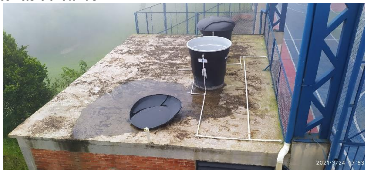
Foto N° 12. Red hidráulica de tanques averiada – OCI 24-03-2021
