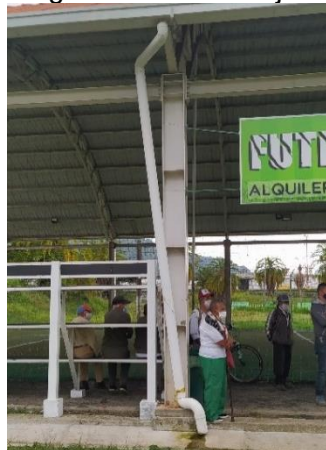
Foto N° 58. Falencia en aseguramiento de bajantes de aguas lluvias – OCI 24-03-2021
