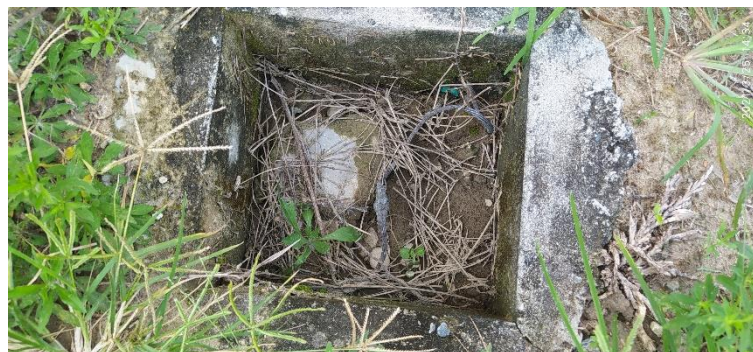
Foto N° 102. Sistema de polo a tierra sin protección – OCI 25-03-2021
