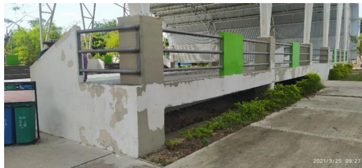
Foto N° 6. Desprendimiento pintura en muros – OCI 25-03-2021
