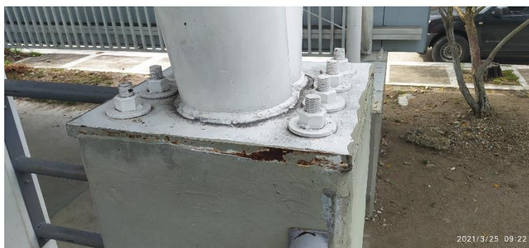
Foto N° 1. Inicios de corrosión en platina – OCI 25-03-2021
