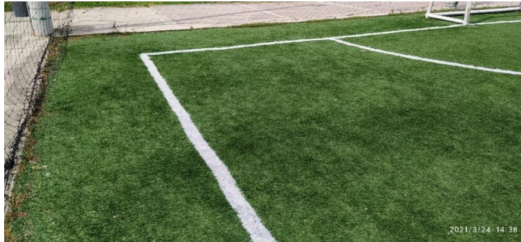
Foto N° 51. Desnivel en grama de la cancha – OCI 24-03-2021
