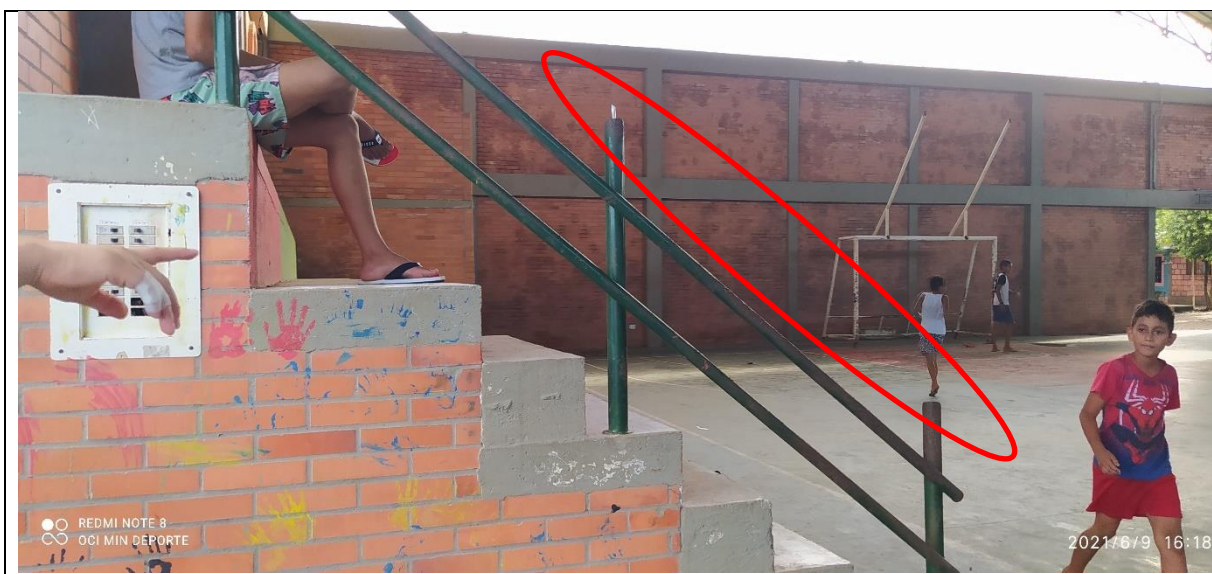
Foto N°. 1. Se evidencia posible pérdida de algunos elementos de las barandas de graderías del polideportivo.
