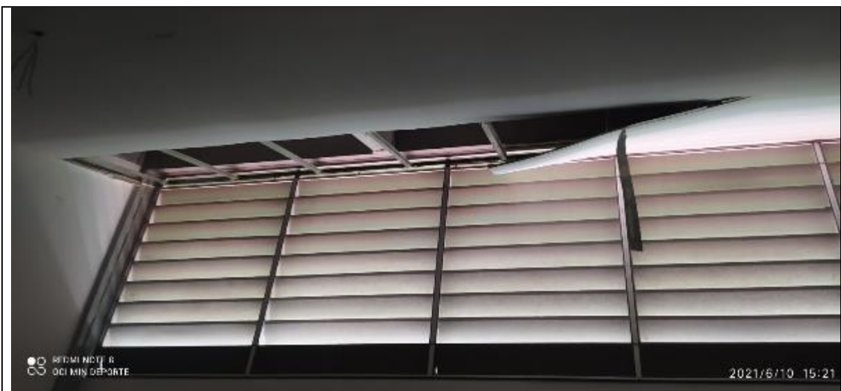
Foto No. 5. Evidencia de desprendimiento de cielo raso por humedad.
