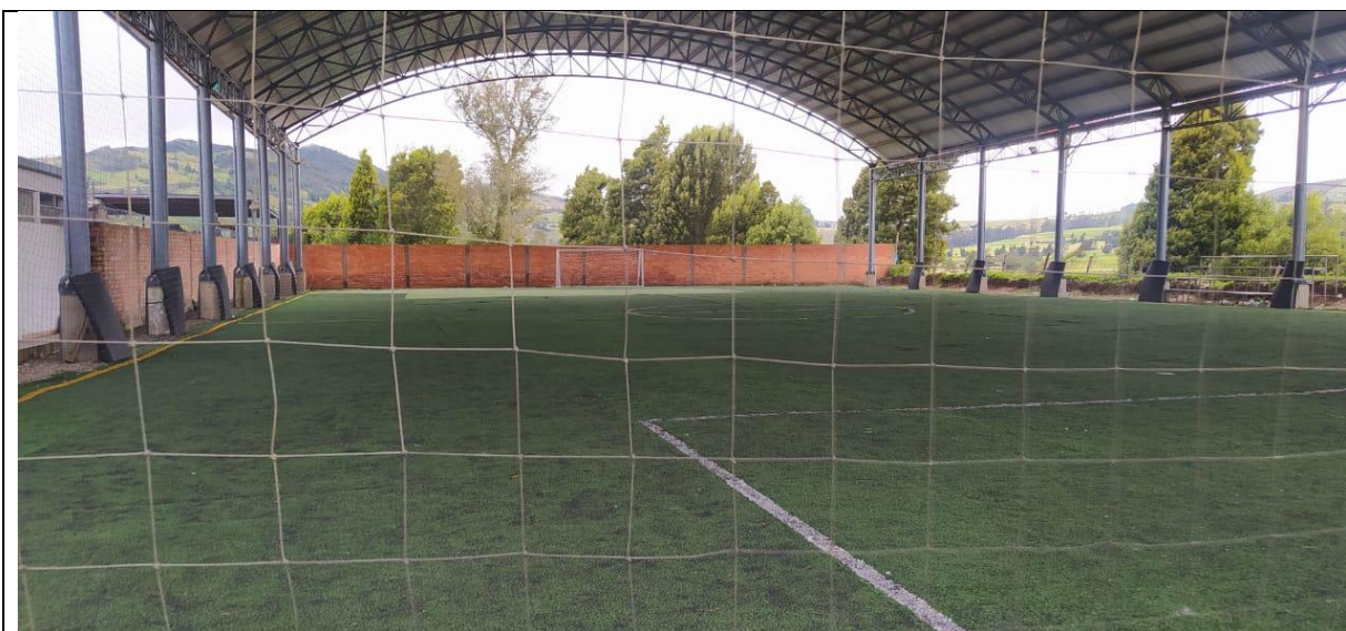
Foto N°. 11. Se evidencia deficiencia en la instalación de la grama sintética, incumpliendo las especificaciones técnicas correspondiente.
