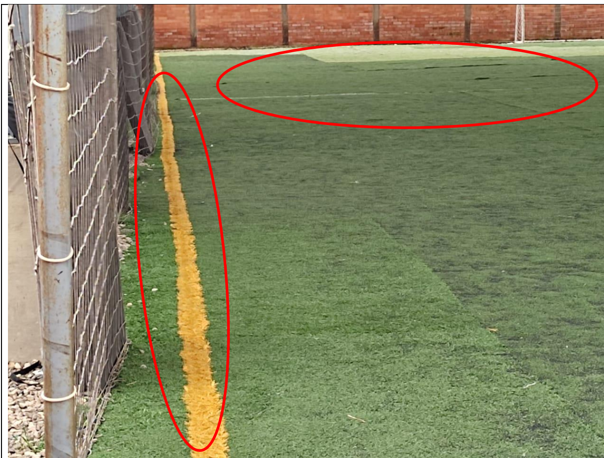
Foto N°. 14. Se evidencia deficiencia en la instalación de la grama sintética, incumpliendo las especificaciones técnicas correspondiente. Las líneas de demarcación no son homogéneas. Se evidencia sobre saltos en unión de material.
