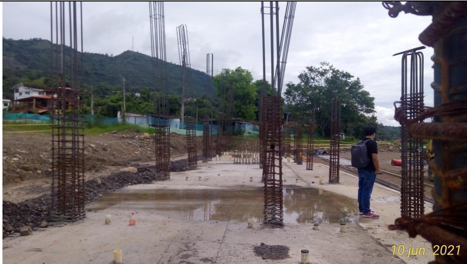
Foto No. 23. El área de graderías se encuentra con cimentación terminada, se evidencia exposición a intemperie de hierro de arranque escaleras, columnas y flejes, oxidados.
