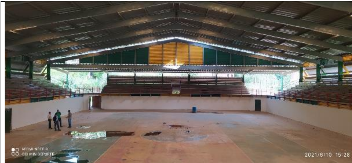
Foto No. 4. Se evidencia agua en el sector en el cual se realizará instalación de piso en Maderamen en Polideportivo Villa Olímpica del municipio de Floridablanca Santander.
