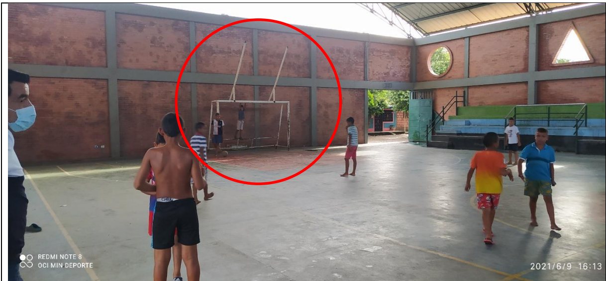
Foto N°. 3. Se evidencia que los tableros de las canchas están averiados
