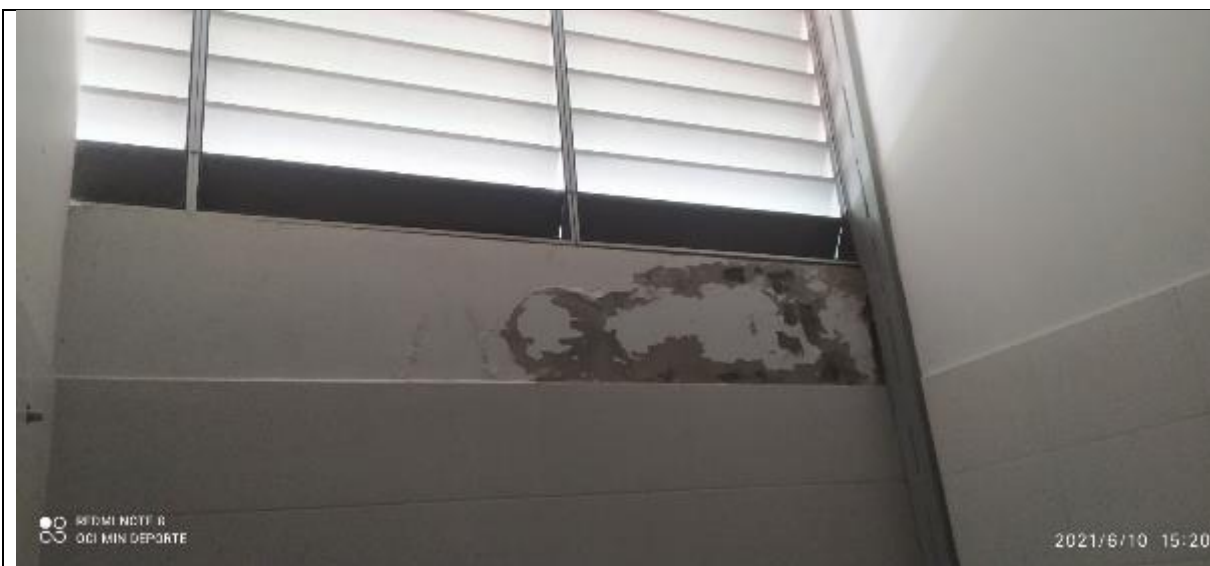
Foto No. 6. Evidencia de humedad en muros cercanos a ventanas.
