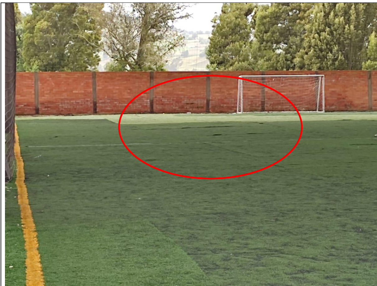
Foto N°. 13. Se evidencia deficiencia en la instalación de la grama sintética, incumpliendo las especificaciones técnicas correspondiente. En la uniones se evidencia que el material esta suelto y con sobre saltos.
