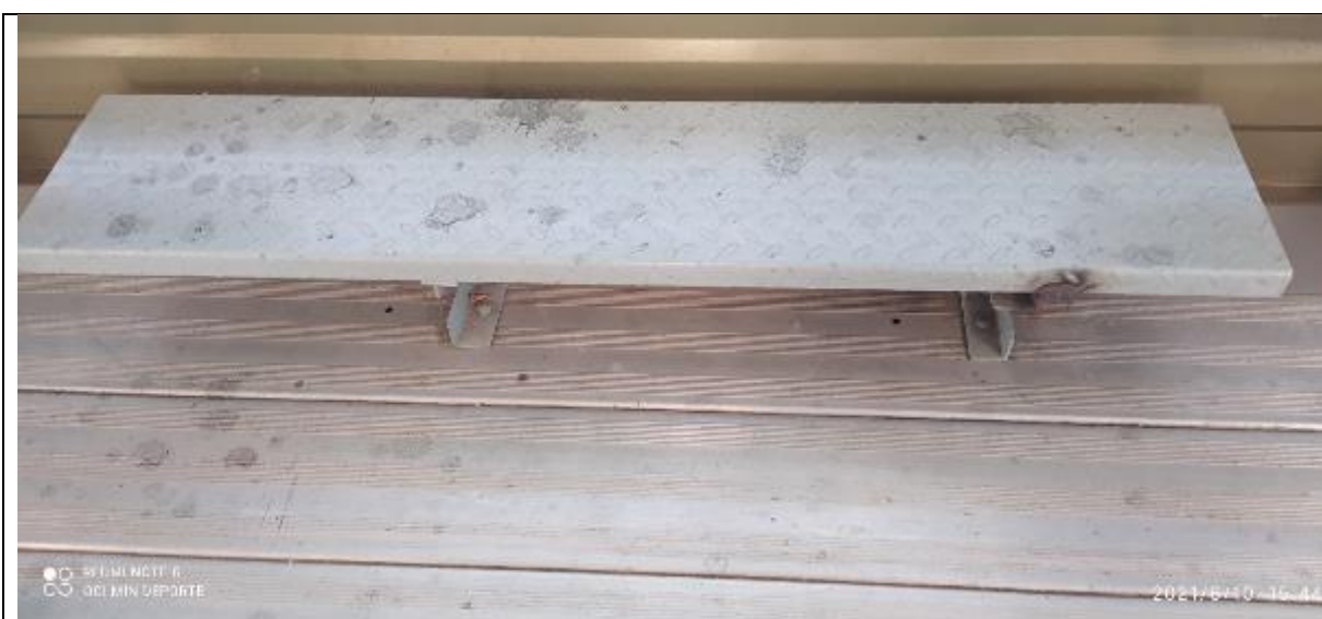
Foto No. 7. Evidencia de detalles constructivos que no cumplen especificación técnica en obras realizadas en gradería.
