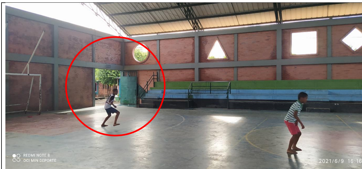
Foto N°. 2. Se evidencia que las puertas de acceso al polideportivo se encuentran averiadas y desprendidas del marco.
