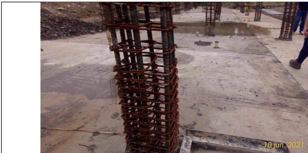
Foto No. 24. El área de graderías se encuentra con cimentación terminada, se evidencia exposición a intemperie de hierro de arranque escaleras, columnas y flejes, oxidados.
