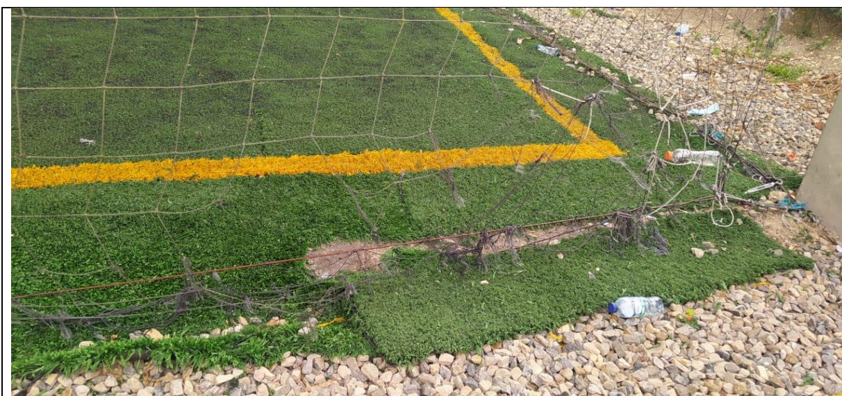
Foto N°. 12. Se evidencia deficiencia en la instalación de la grama sintética, incumpliendo las especificaciones técnicas correspondiente.
