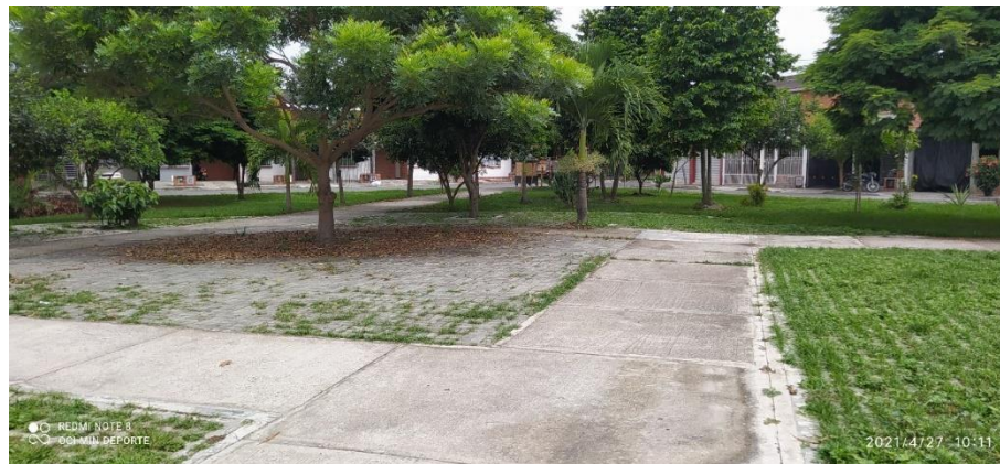
Foto No 6. Desnivel en piso gramoquin parque infantil Urbanización La Aldea Corregimiento Villagorgona – OCI 27/04/2021
