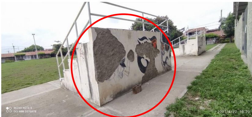
Foto No 10. Evidencia de deficiencia en pañete y pintura de gradería cancha Urbanización La Aldea Corregimiento Villagorgona – OCI 27/04/2021
