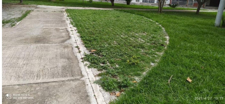
Foto No 5. Evidencia falta mantenimiento y desnivel en piso gramoquin Urbanización La Aldea Corregimiento Villagorgona – OCI 27/04/2021
