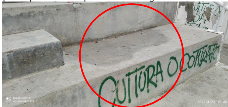
Foto No 11. Evidencia de empozamiento de agua en gradería de cancha Urbanización La Aldea Corregimiento Villagorgona – OCI 27/04/2021
