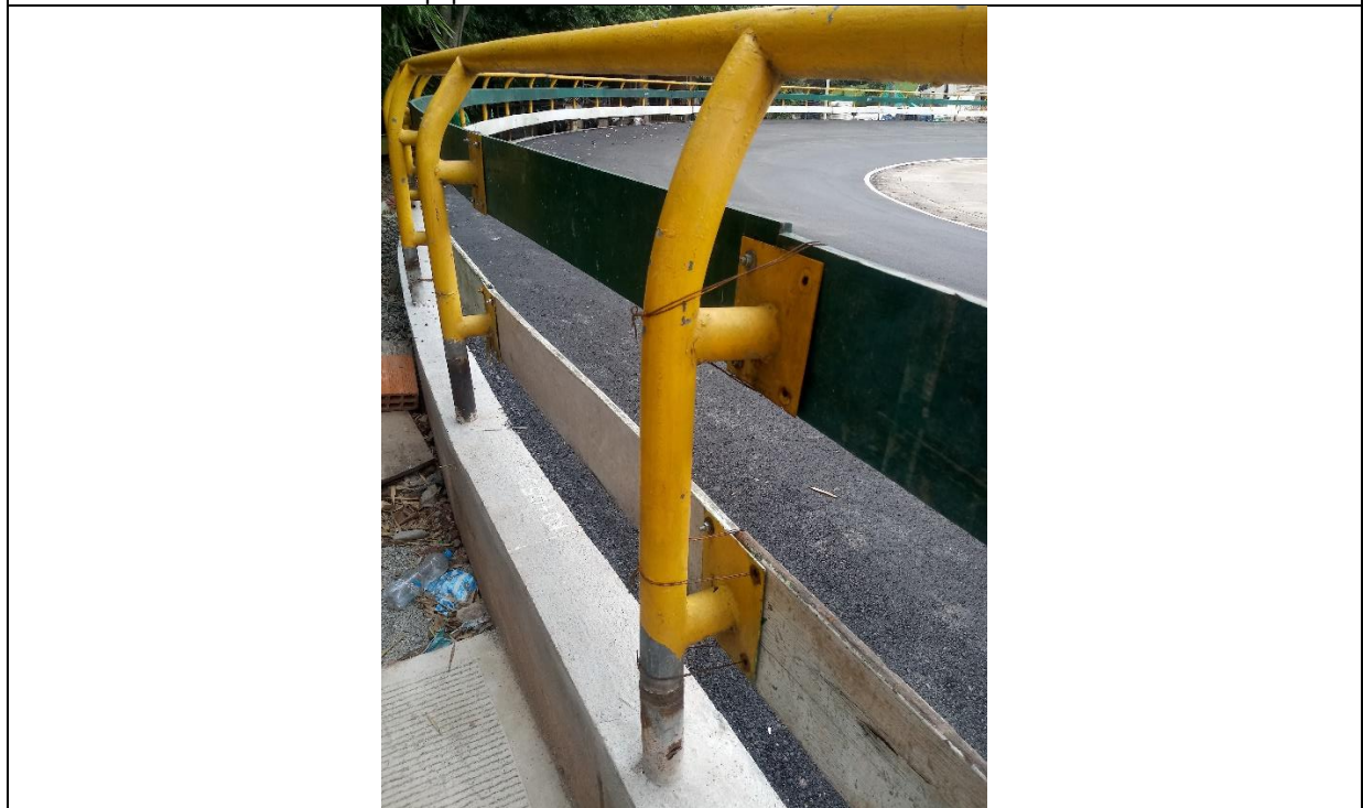
Foto No. 2, Cerramiento perimetral pista de patinaje. Se evidencia que las tablas de cerramiento y protección, algunas están sujetas con alambres. Foto: equipo auditor Oficina de Control Interno. 10-07-2019.
