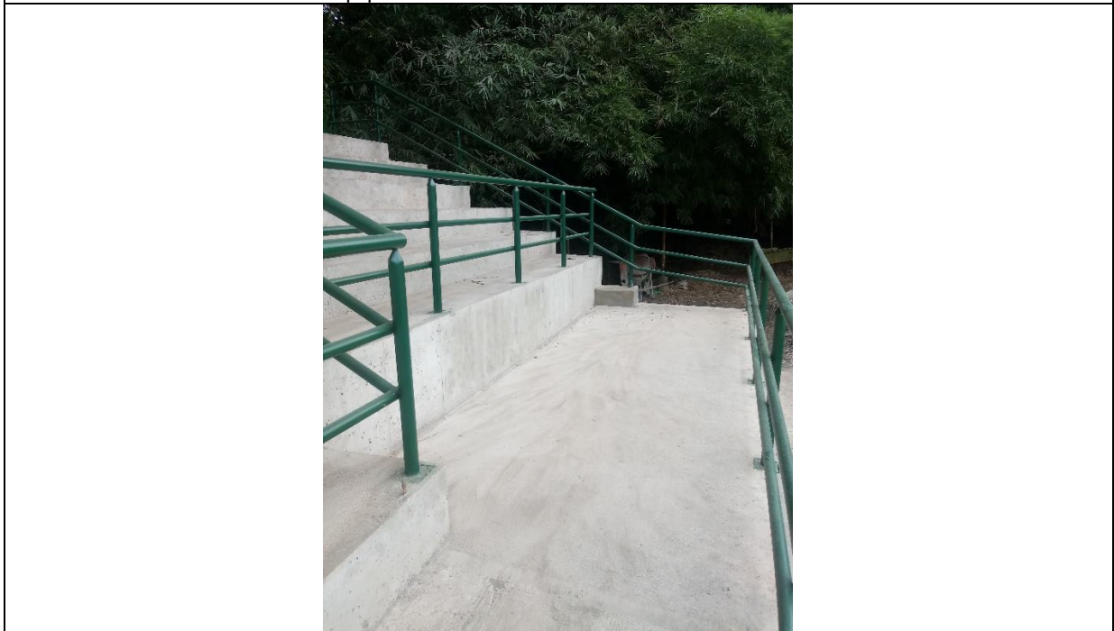
Foto No.4, Zona para discapacitados. Pendiente señalización. Foto: equipo auditor Oficina de Control Interno. 10 -07-2019.
