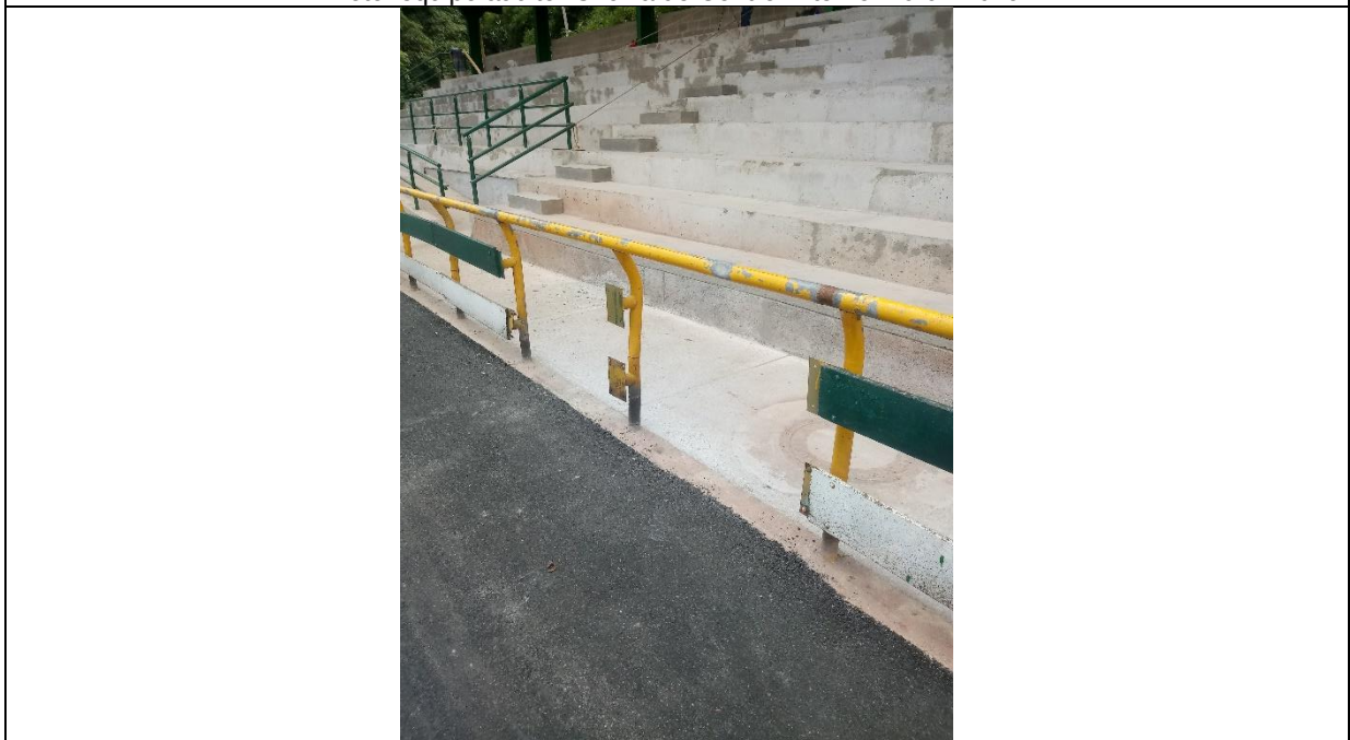
Foto No.12, Baranda perimetral cierre pista de patinaje. Foto: equipo auditor Oficina de Control Interno. 10-07-2019
