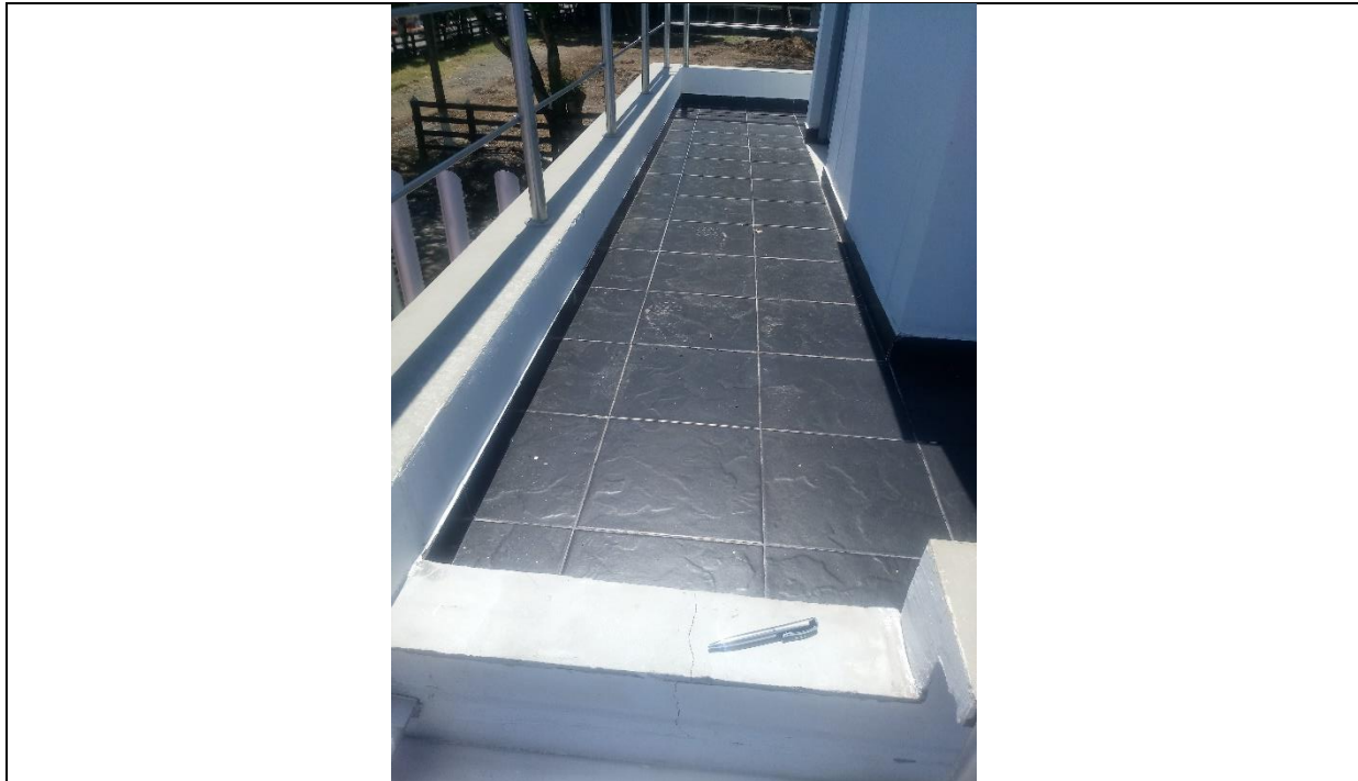
Fotos No.17, Fisura paso escaleras a zona cabina de locución 2do piso. Foto: equipo auditor Oficina de Control Interno. 11-07-2019
