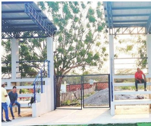
Fotografía 11. Puerta caída en entrada principal por falla en bisagra
