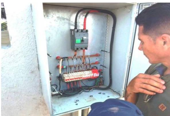
Fotografía 13. Caja principal del circuito eléctrico para las luminarias (imagen tomada por la CGR en la visita de abril de 2024)
