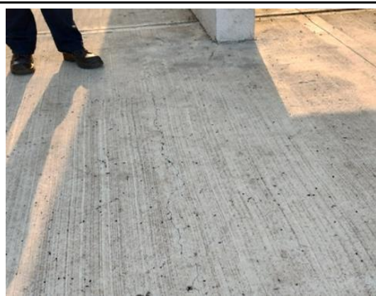
Fotografía 24. Placa fisurada a la entrada p/pal Gradería costado Norte. (imagen tomada por la CGR en la visita de abril de 2024)
