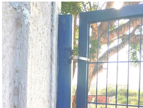
Fotografía 12. Puerta principal caída por bisagra no adecuada.
