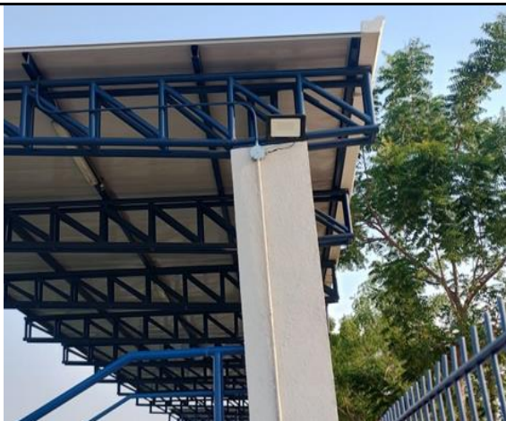
Fotografía 19. Reflector apagado esquina Nor-occidente – Graderías. (imagen tomada por la CGR en la visita de abril de 2024)
