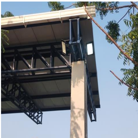
Fotografía 17. Reflector apagado en esquina Sur occidente – Graderías. (imagen tomada por la CGR en la visita de abril de 2024)
