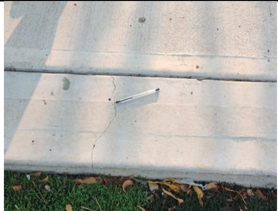
Fotografía 22. Detalle de fisura en Bordo de confinamiento. (imagen tomada por la CGR en la visita de abril de 2024)
