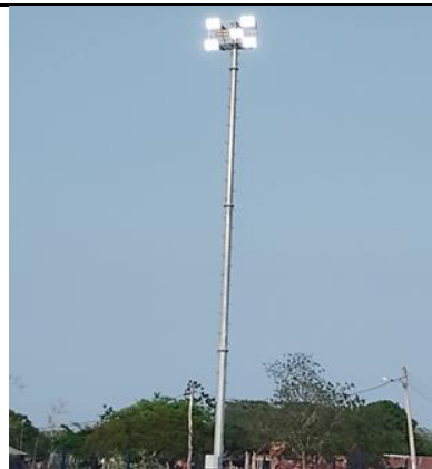
Fotografía 16. Esta produce fallas en las luminarias de la cancha. (imagen tomada por la CGR en la visita de abril de 2024)
