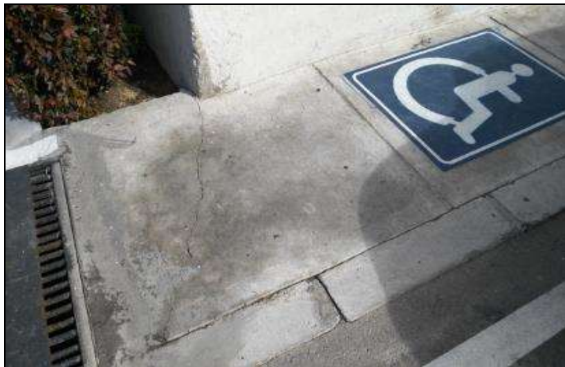
Foto No. 24: Vista general andén perimetral junto a acceso vehicular principal. La sección de concreto presentado en la imagen evidencia fisura diagonal sobre el tercio medio.
