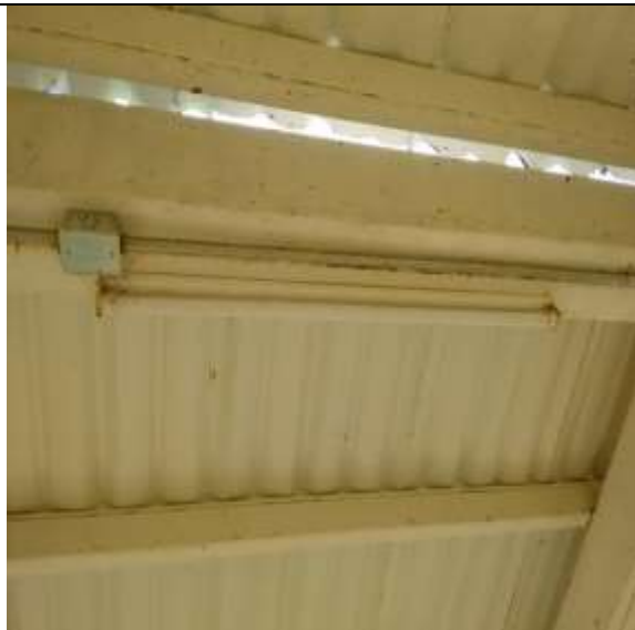
Foto No. 80: Luminaria de 1*32
