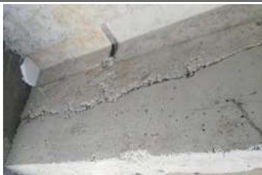
Foto No. 54: Detalle viga de concreto, gradería occidental, tramo nuevo. Se aprecia el hormigueo excesivo sobre todas las caras del concreto.
