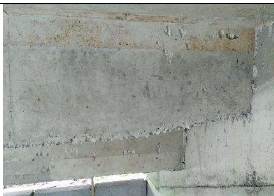
Foto No. 56: Detalle viga de concreto, gradería occidental, tramo nuevo. Se aprecia en esta zona la disminución de la sección de la viga de manera abrupta (tramo de viga ubicada en la gradería occidental, zona sur).
