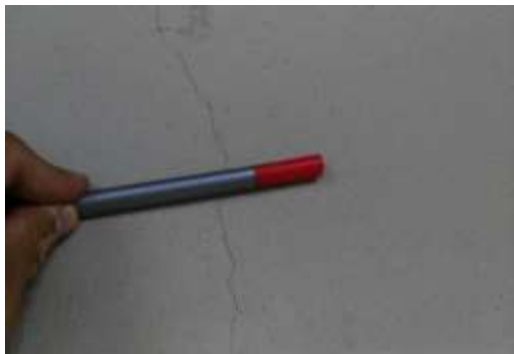
Foto No. 52: Detalle viga de concreto, túnel FIFA. Se aprecia fisura vertical, la cual es recurrente en varios tramos de concreto.
