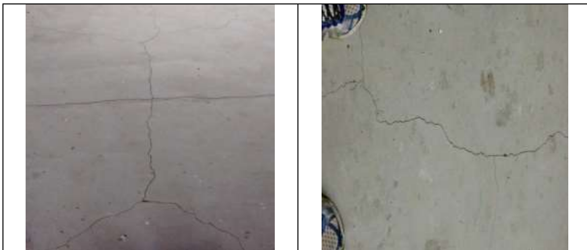
Foto No. 87: Fotos con agrietamientos de placa entre piso e= 0,35 m
