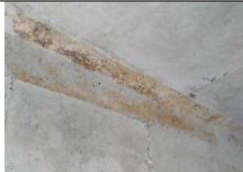
Foto No. 55: Detalle viga de concreto, gradería occidental, tramo nuevo. Se aprecia manchado del concreto por acumulación de humedad en este espacio, ubicado en la parte inferior de la gradería construida.
