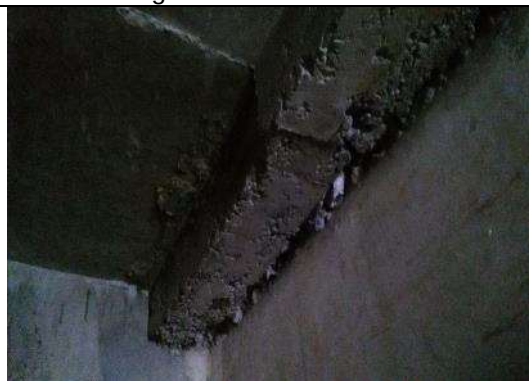
Foto No. 57: Detalle viga de concreto, gradería occidental, tramo nuevo. Se aprecia el hormigueo excesivo. En la zona norte de esta gradería, la cual registra la imagen, se evidenció deficiencias en la técnica constructiva implementada.
