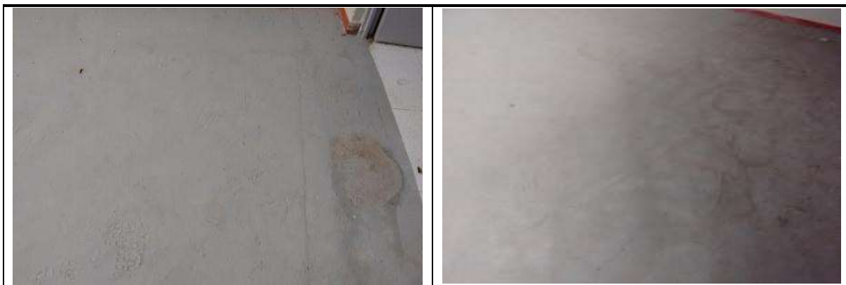
Foto No. 85: pisos con mal terminado, sin brillo y mal nivelados
