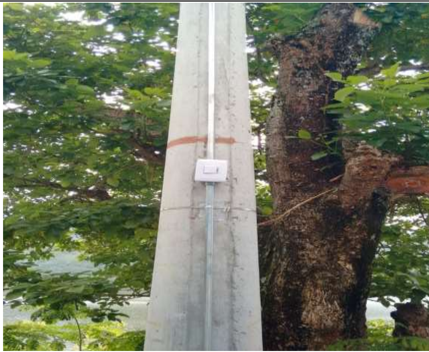
Foto No. 78: Elemento de control luminarias Malecón Fuente: foto tomada por auditor en obra
