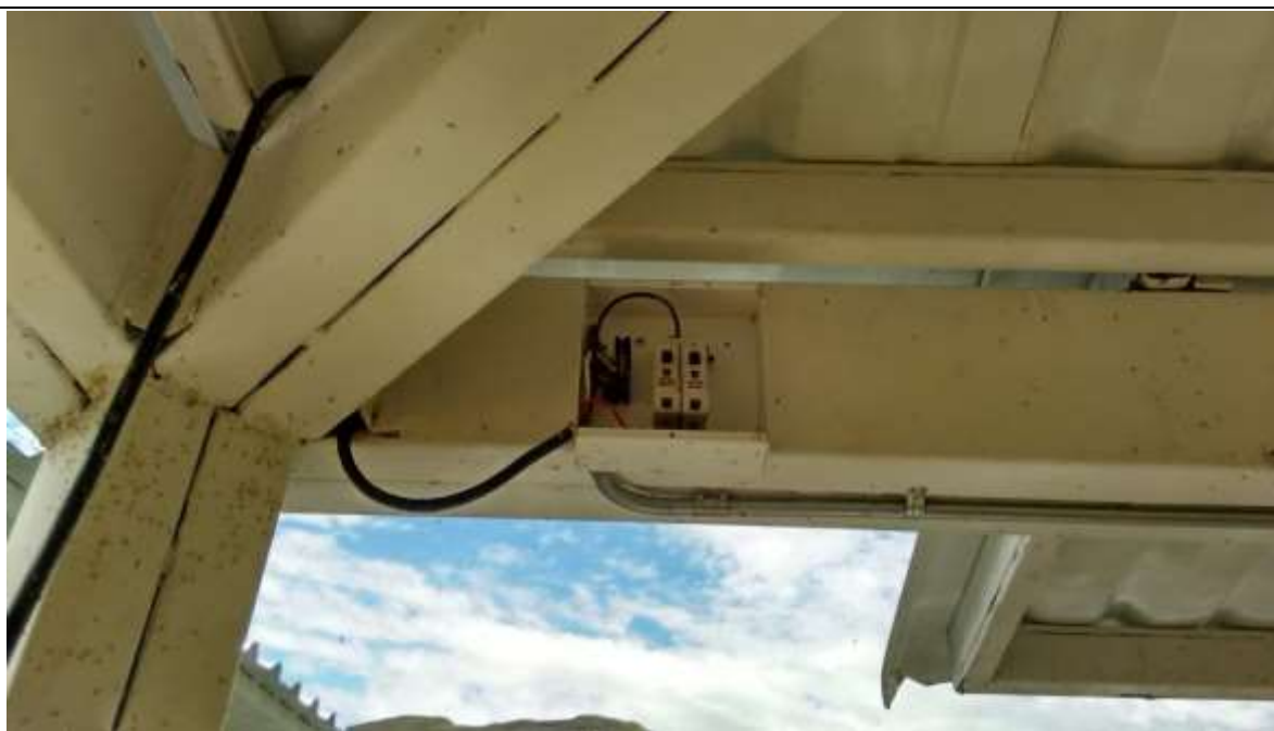
Foto No. 82: Caja eléctrica Fuente: Fotos de obra tomadas por auditor
