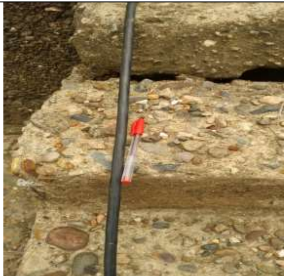
Foto No. 81: Cable en obra
