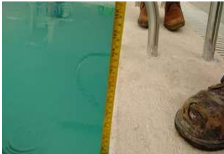
Foto No. 21: Granito con mal acabado Fuente: Equipo auditor
