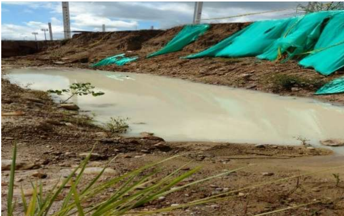
Foto No. 2: Estado de las obras - Muro de contención (con alud y empozado) Fuente: Equipo Auditor visita in situ
