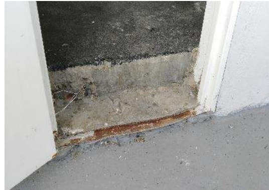
Foto No. 51: Detalle marco puerta ingreso a baño hombres tercer nivel, gradería occidental. Misma patología detallada en la imagen anterior.
