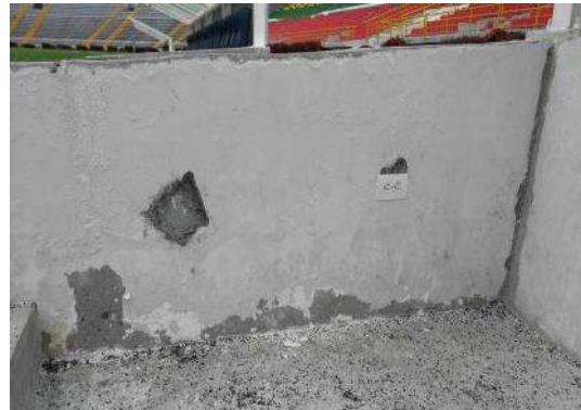
Foto No. 65: Detalle muro perimetral banco de árbitros. Se observa en la imagen las deficiencias de calidad y construcción de la pintura de acabado sobre el elemento. De igual manera, se aprecia la deficiencia en la salida eléctrica.
