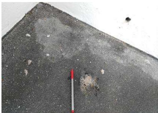
Foto No. 44: Detalle acabado placa de concreto baño de mujeres tercer nivel de la gradería occidental. El acabado del concreto presenta deficiencias constructivas, evidenciado en la pérdida parcial de material.
