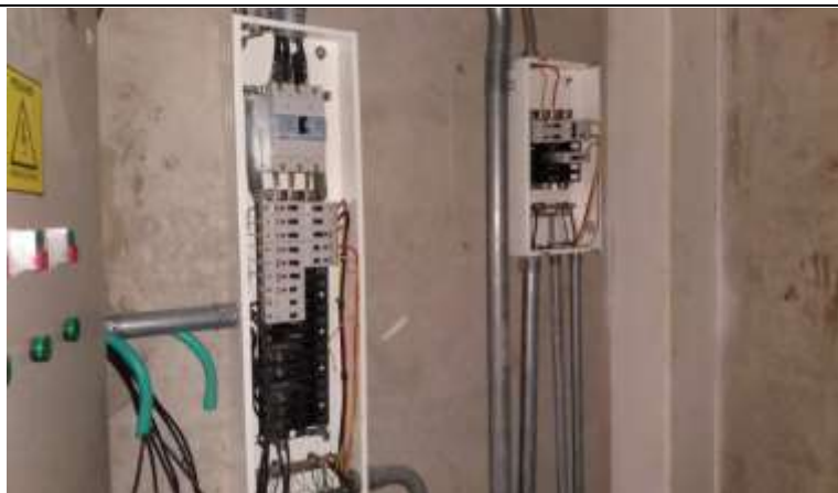
Foto No. 102: Circuitos eléctricos sin terminar de conectar.
