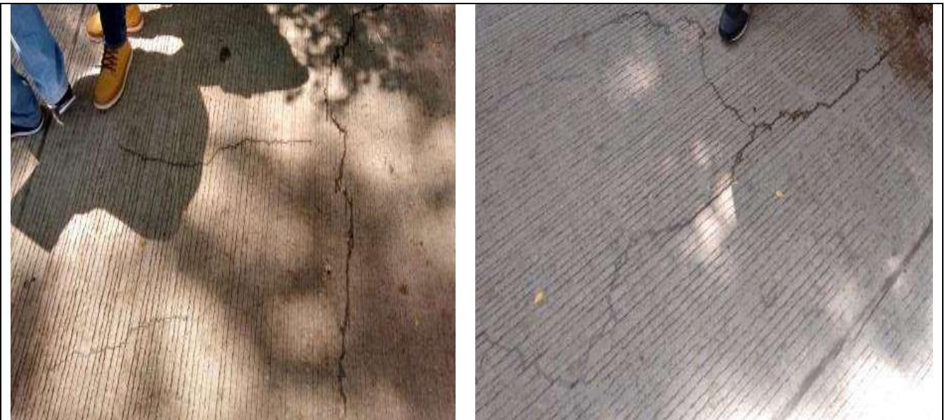
Foto No. 77: Losas agrietadas Fuente: fotos tomadas por auditor en visita
