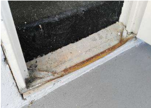
Foto No. 50: Detalle marco puerta ingreso a baño mujeres tercer nivel, gradería occidental. Se aprecia en la parte inferior del marco corrosión excesiva y deformación del elemento metálico.
