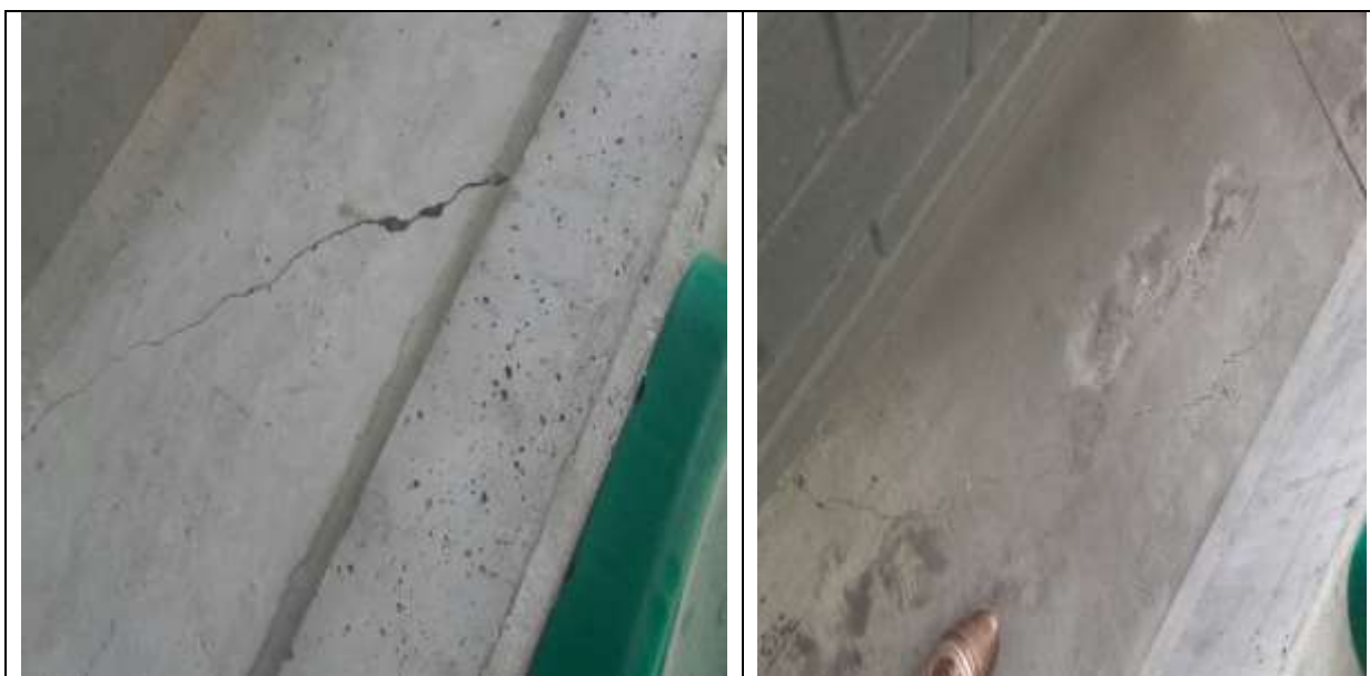
Foto No. 89: Fisuras de Graderías
