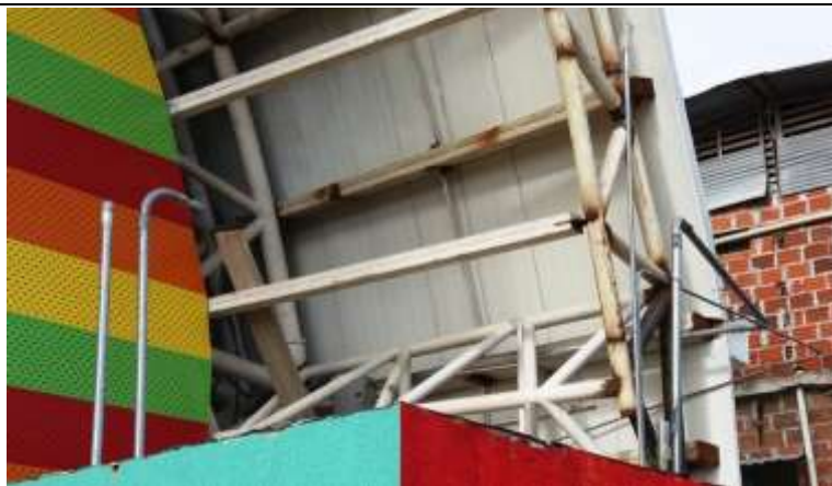
Foto No. 101: Punto de soldadura sin pintar y conductos eléctricos sin terminar.
