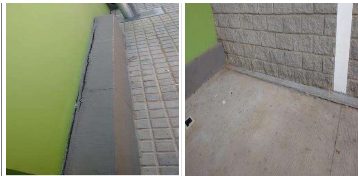
Foto No. 90: Asentamiento de los pisos en loseta
