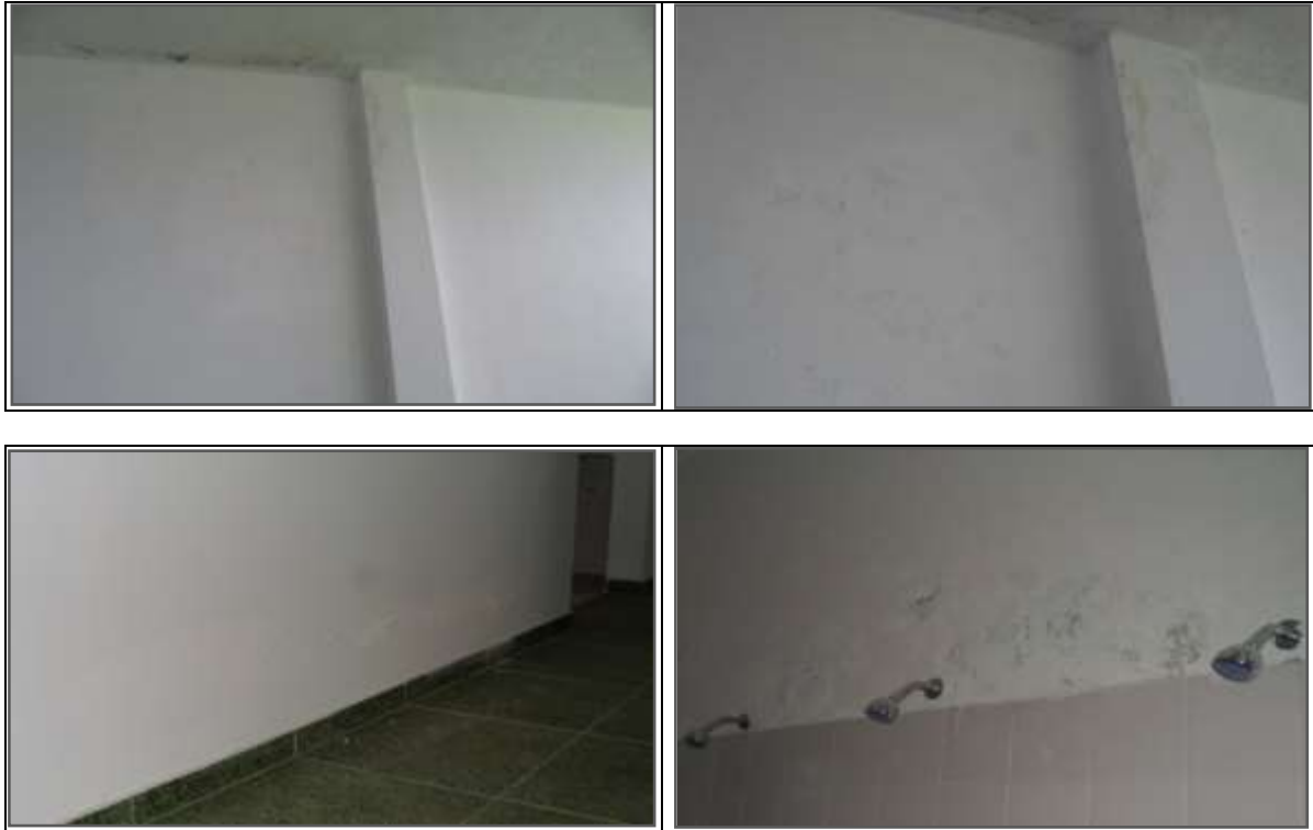
Foto No. 95: Impermeabilización de la placa de cubierta en camerinos averiada
