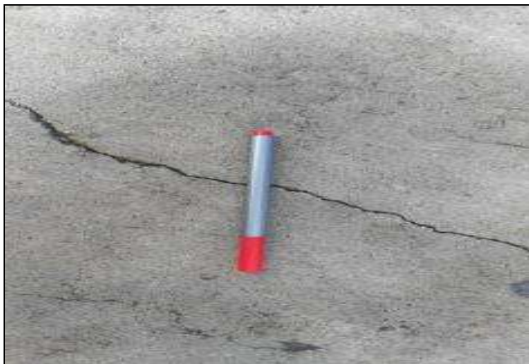
Foto No. 25: Detalle fisura andén imagen anterior. De acuerdo con la escala utilizada (marcador), la fisura tiene una abertura aproximada de 2 mm. Fuente: Equipo Auditor CGR, junio de 2016.
