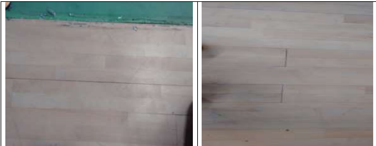
Foto No. 23: Maderamen con mal acabado, ondulaciones y dilataciones
