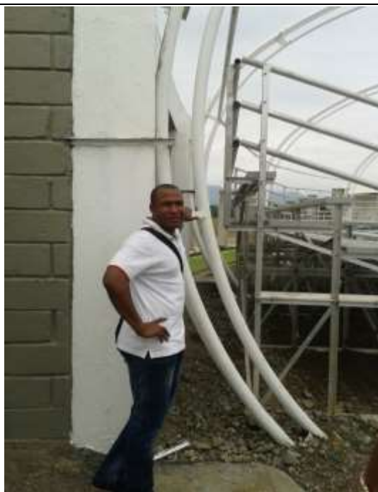
Foto No. 98: Estructura de cubierta anclada al piso y recostada en las columnas.
