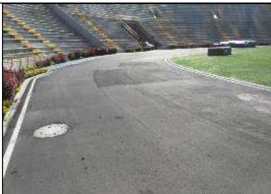
Foto No. 26: Vista general acceso vehicular zona norte del estadio, donde se evidenciaron falencias en calidad del producto terminado.
