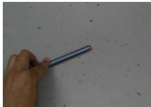
Foto No. 53: Detalle viga de concreto, túnel FIFA. Se aprecia en la imagen el hormigueo.
