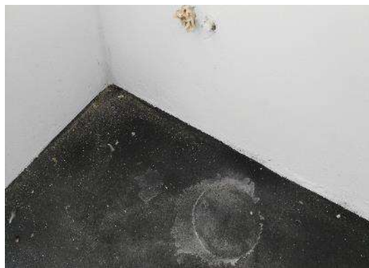
Foto No. 45: Detalle acabado placa de concreto baño de mujeres tercer nivel de la gradería occidental.
