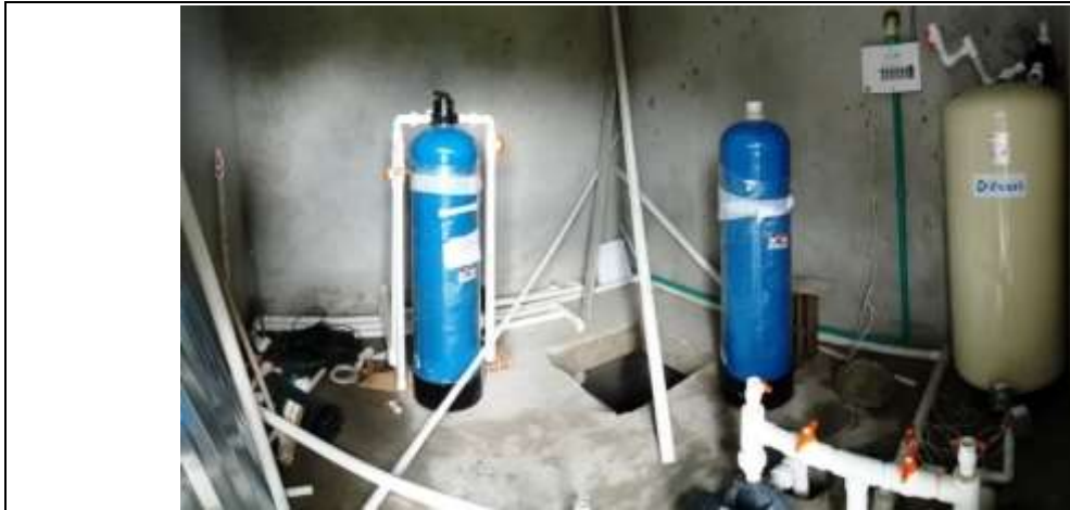
Foto No. 103: Equipos de la planta de tratamiento sin terminar de instalar.
