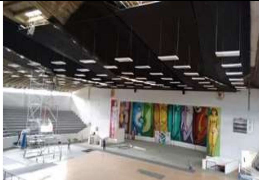
Foto No. 22: Cielo raso en BLACK TEATHER, mal construido y sin cubrir todo techo.
