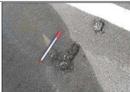
Foto No. 27: Detalle asfalto, acceso vehicular zona norte del estadio. Como se aprecia en la imagen, se evidenciaron hundimientos puntuales y distribuidos en toda el área asfaltada. Se presenta desprendimiento de la arena y gravas de la mezcla de concreto asfáltico, comprometiendo la estructura del mismo.
