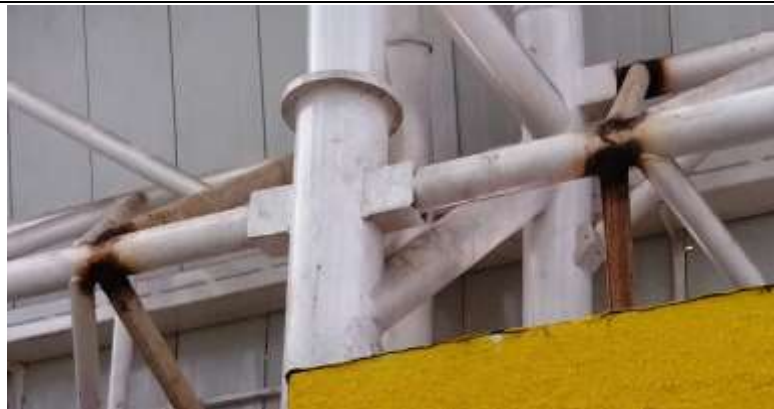
Foto No. 100: Puntos de soldadura sin pintar.
